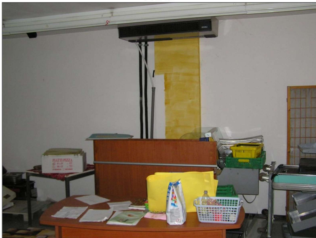
Lotto 3: bene A, locale vendita, termoconvettori
