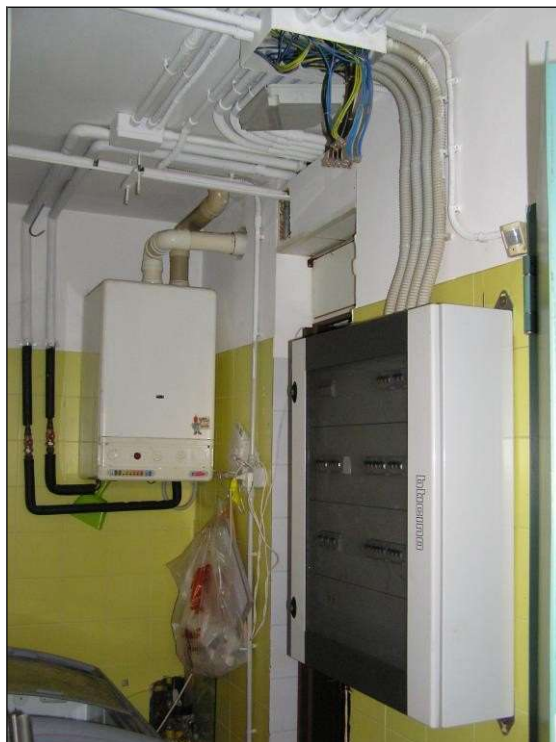
Lotto 3: bene A, laboratorio macelleria, caldaia a gas e impianti elettrici
