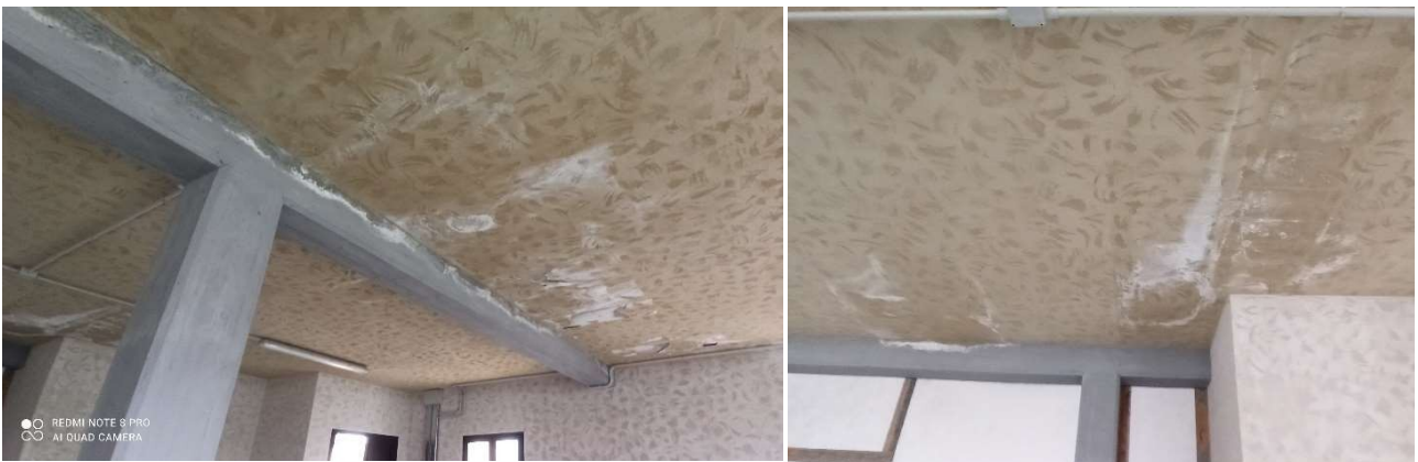
vista interna piano primo lato sx, sub.10 – efflorescenza intradosso del solaio
