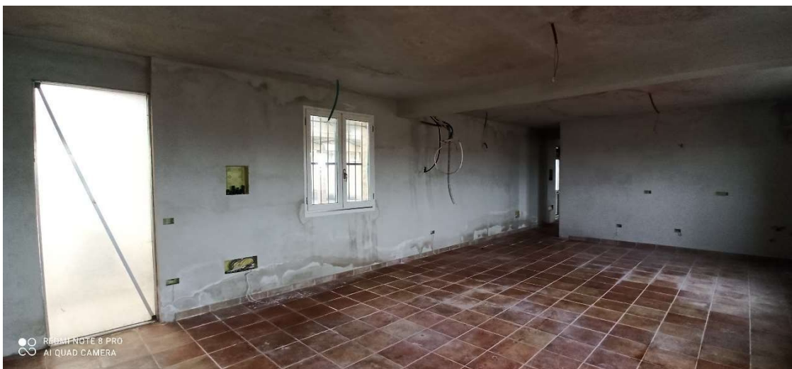
vista ufficio 2 sub.13 - non finito (mancano le tramezzature)
