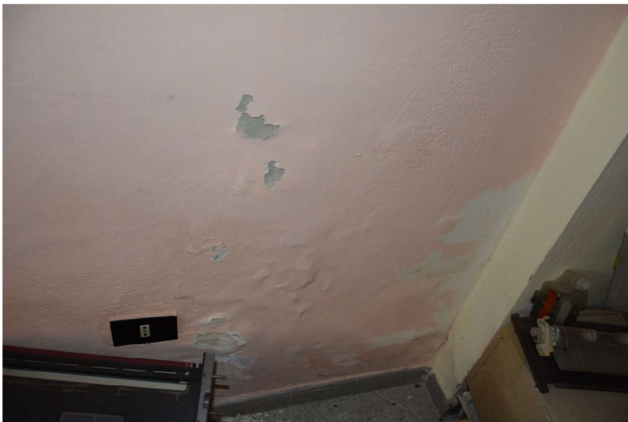
FOTO 16_ SEGNI DI UMIDITÀ DI RISALITA
