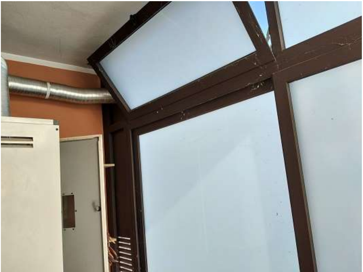
Balcone pranzo soggiorno con chiusura a vetrate da rimuovere
