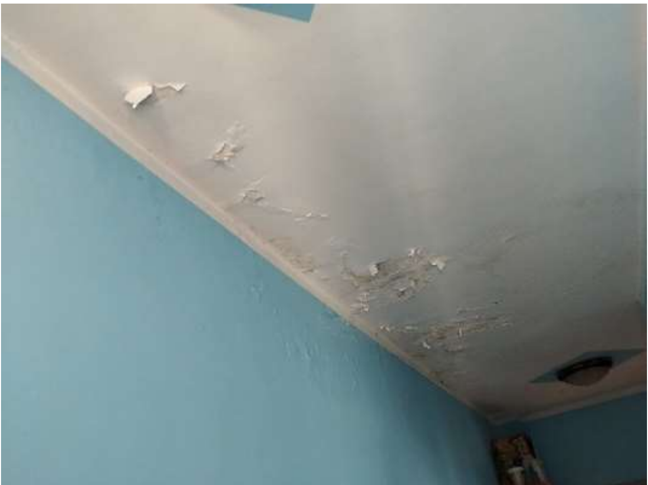
Particolare umidità (corridoio)
