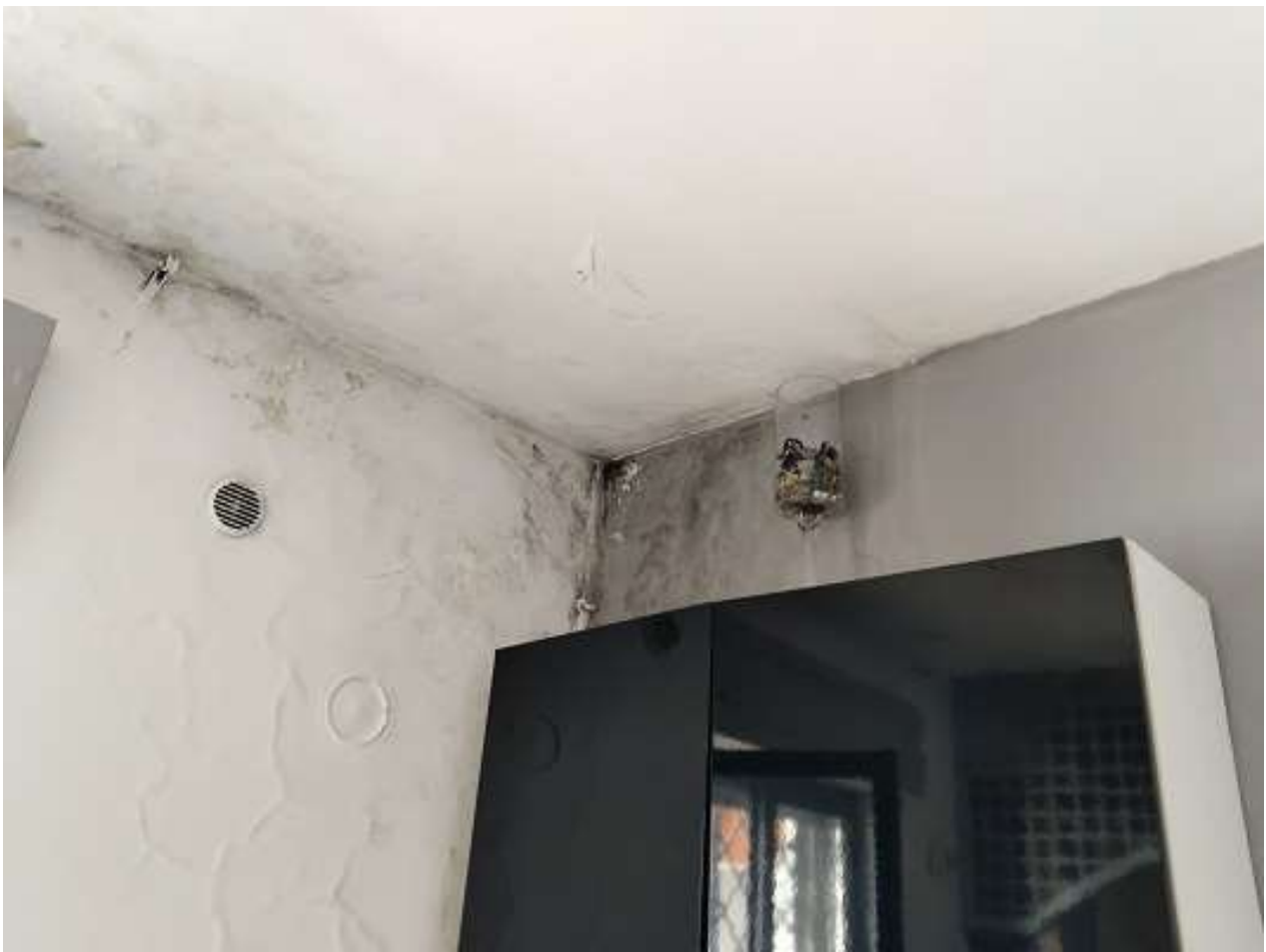
Particolare umidità (pranzo soggiorno)
