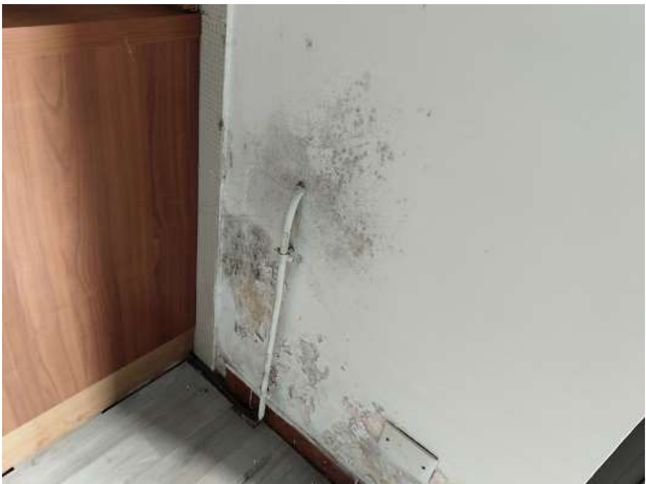
Particolare umidità (pranzo soggiorno)
