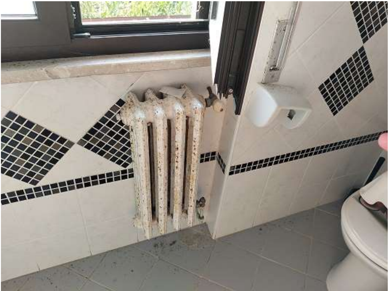
Particolare termosifone in ghisa
