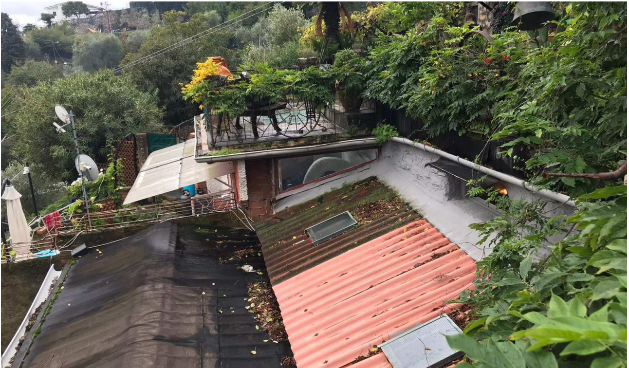
Immobile n.ro 6 – mappale 1380 sub 1 Vista delle coperture (la parte a sinistra, coperta con guaina bituminosa, non è pignorata, trattandosi del subalterno 2 dello stesso mappale – da pratica edilizia Geom.Lunghi).
