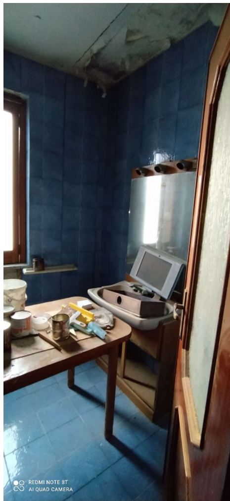
Foto 9 bagno usato come deposito
