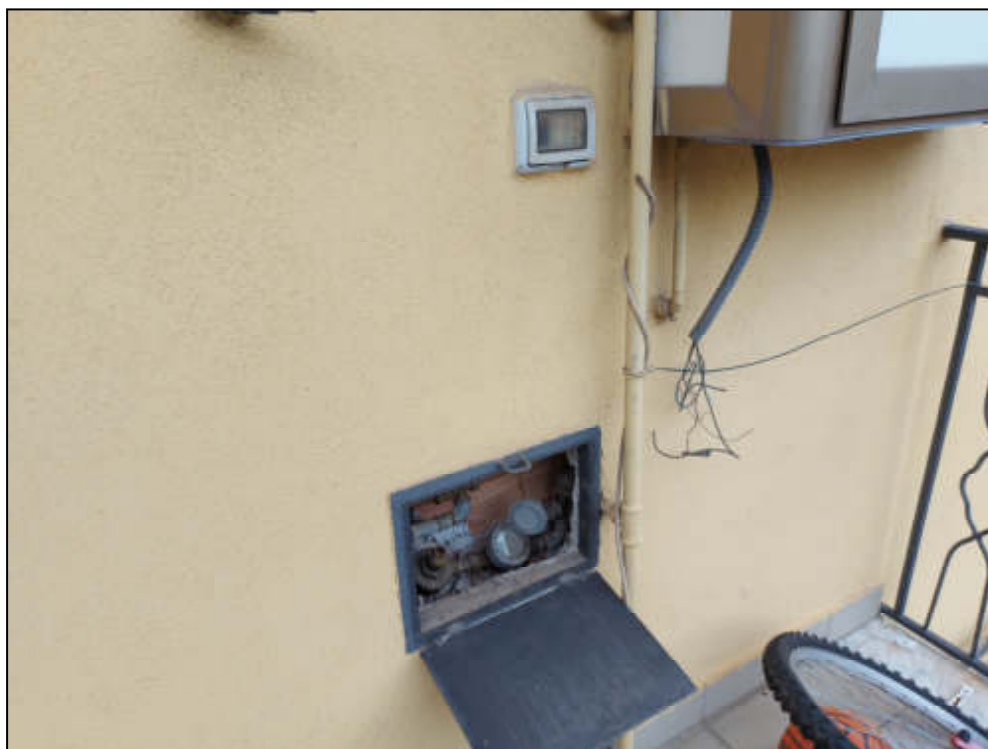
Foto n. 27 - Appartamento – Balconi/Caldaia autonoma non funzionante
