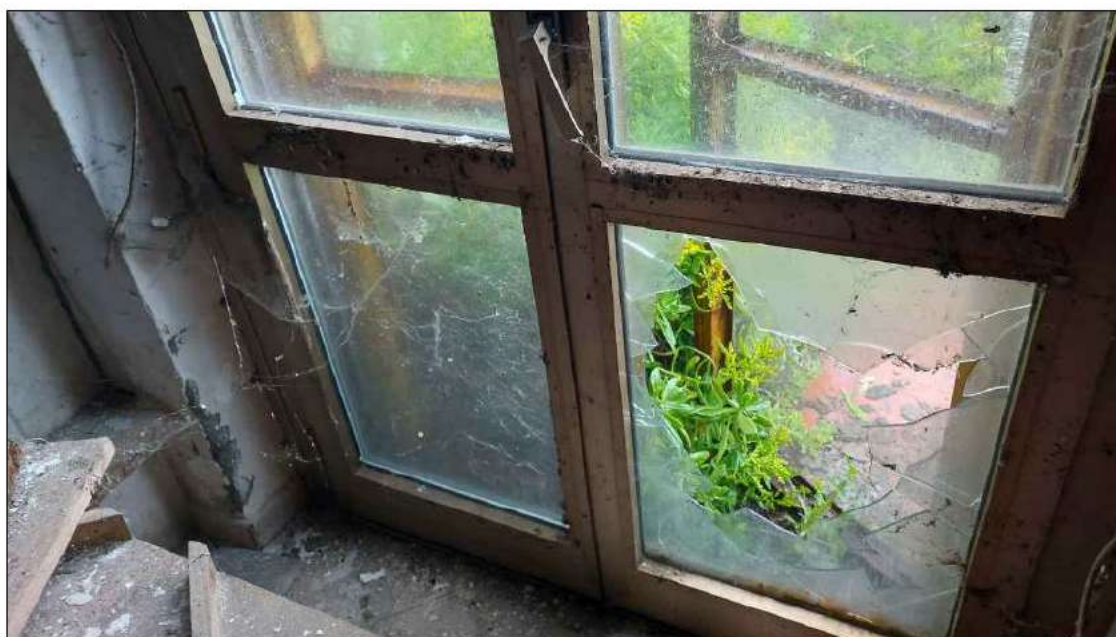
foto 22 - dettaglio della porta finestra della cucina con l'ingresso vandalizzato e il balcone con la vegetazione - Lotto n. 3.
