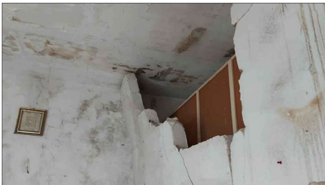
foto 30 - come sopra con dettaglio del divisorio in parte crollato - Lotto n. 3.
