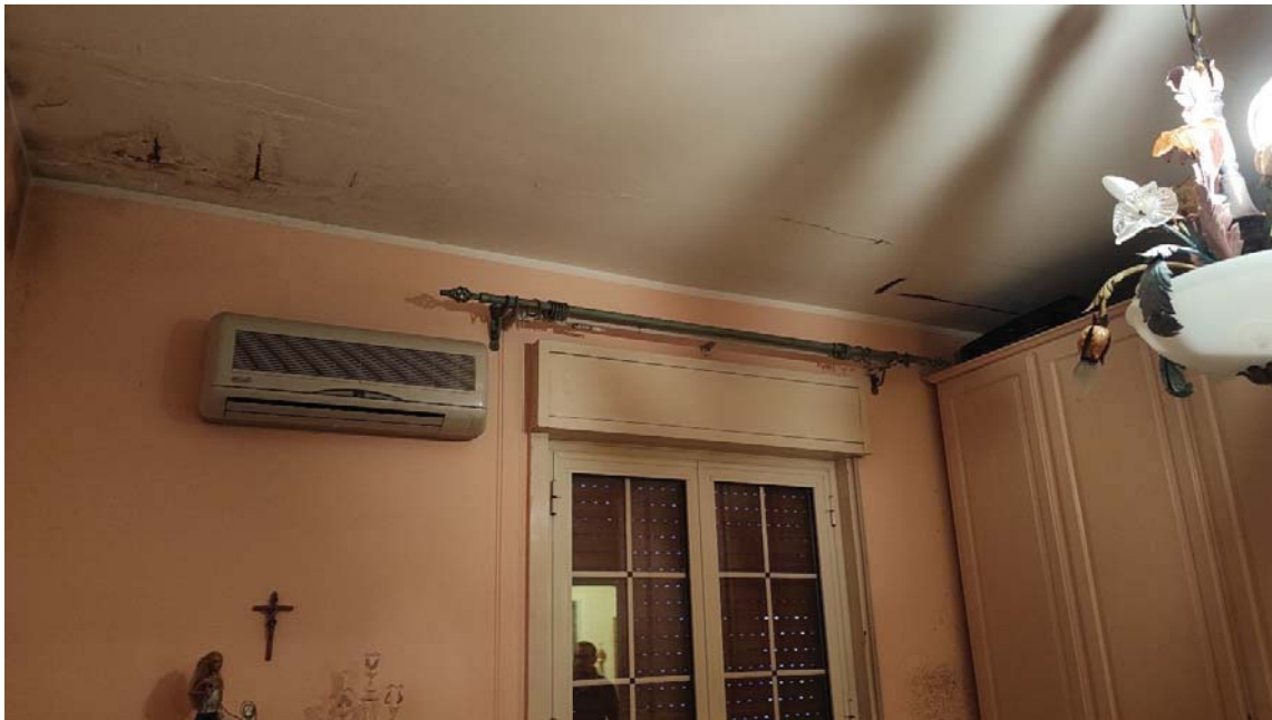
Figure 5 – Particolare del soffitto della camera da letto
