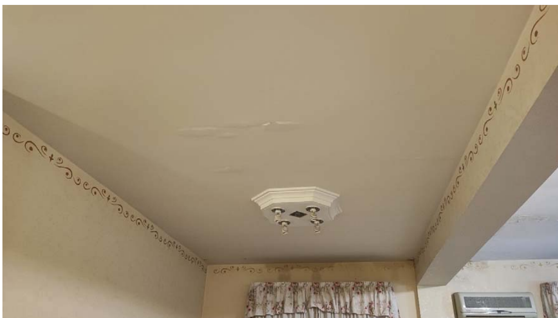
Figure 7 – Particolare del soffitto della camera da letto
