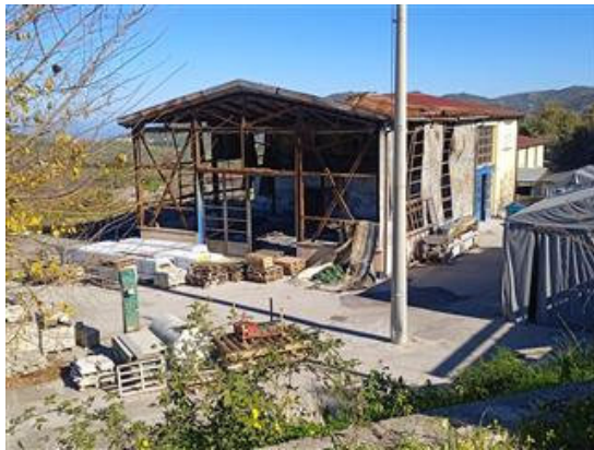
Foto n. 57 Capannone industriale incendiato
