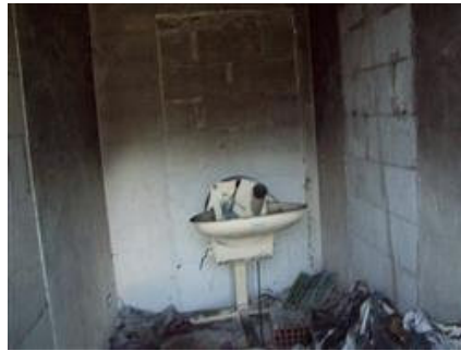
Foto n. 86 bagno ufficio sub 4 distrutto da incendio
