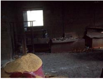
Foto n. 84 uffici sub 4 con ancora materiale incendiato
