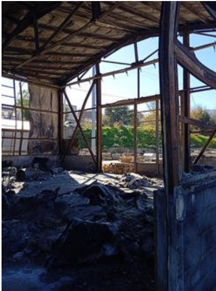
Foto n. 59 interno magazzino con materiale incendiato
