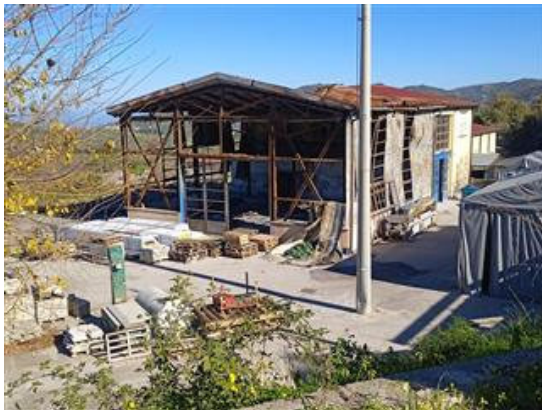
Foto n. 57 Capannone industriale incendiato già inserita nel lotto 7 corpo A
