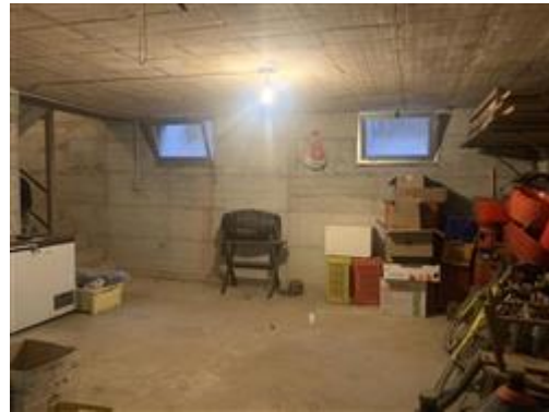
Locale interrato realizzato senza autorizzazione
