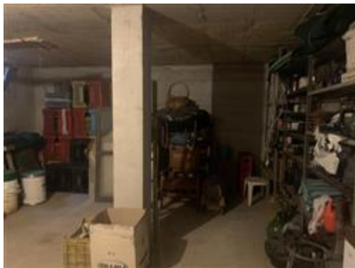
Locale interrato realizzato senza autorizzazione
