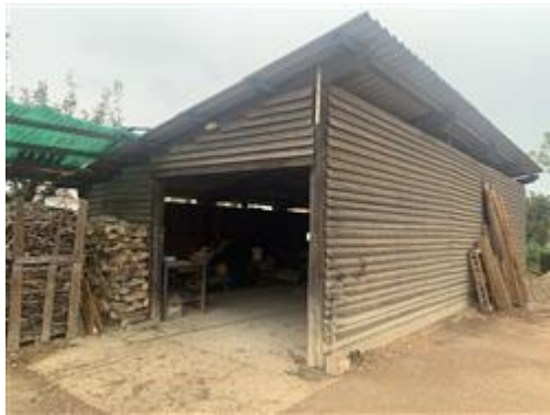
Rimessa attrezzi realizzata senza autorizzazione
