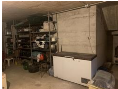
Locale interrato realizzato senza autorizzazione
