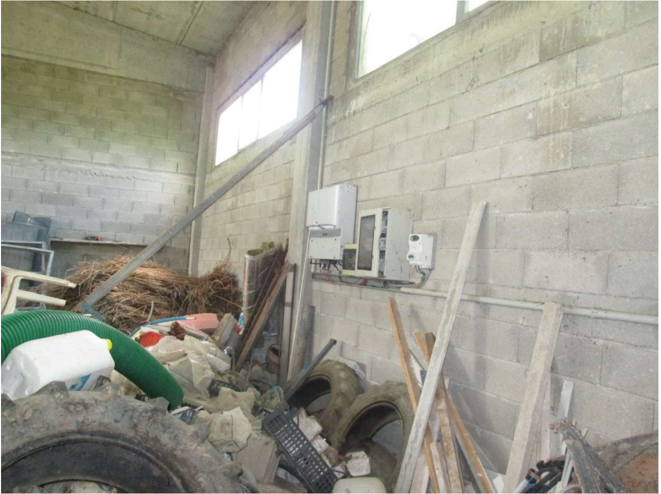
Scatto su parete interna dove sono stati montati i contatori dell'impianto fotovoltaico
