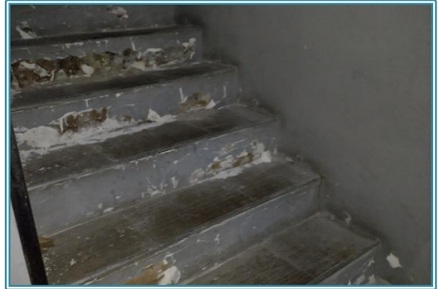
Figura 27 Particolare stato di conservazione della scala
