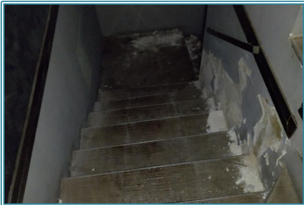
Figura 28 Particolare stato di conservazione della scala
