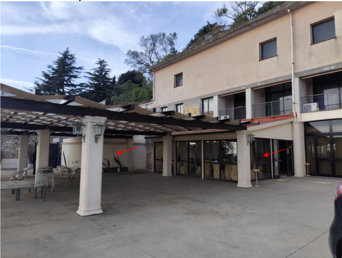
Foto 6 prospetto del ristorante con i volumi abusivi
