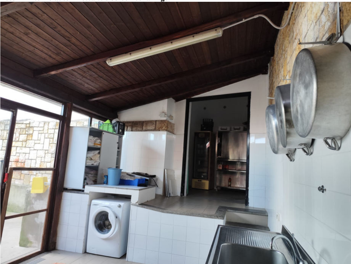
Foto 12 ampliamento abusivo cucina del ristorante sub 30
