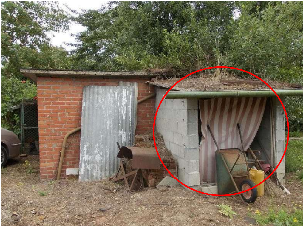
Foto 8 Prospetto ovest box con fabbricato da regolarizzare
