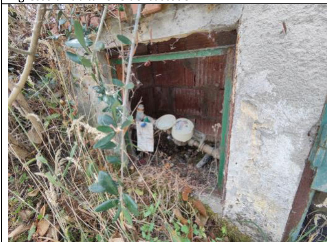
Vano contatore acqua esterno alla recinzione
