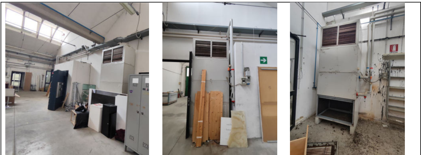
Impianto di riscaldamento ZONA CENTRALE
