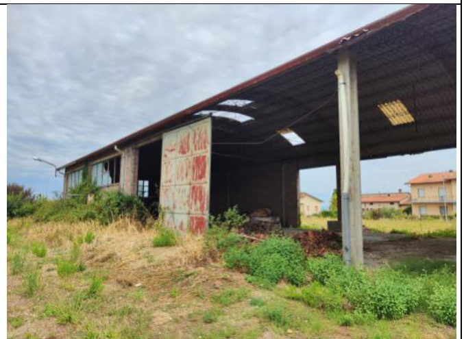
Magazzino con copertura in fibre di amianto
