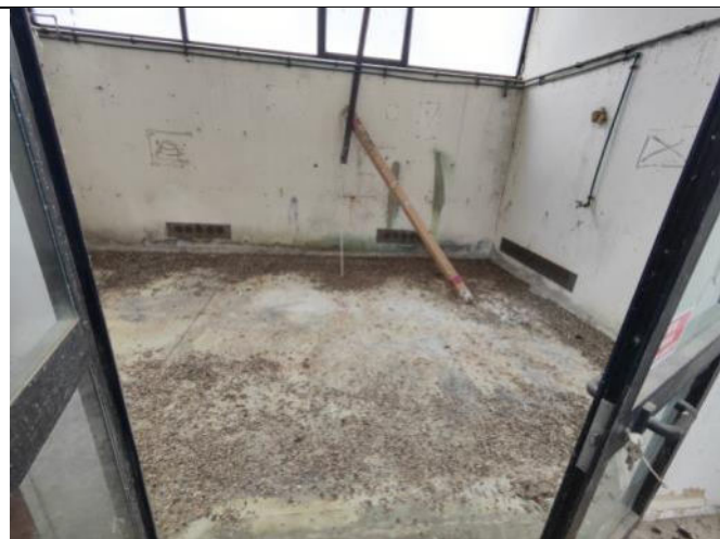
Pavimentazione completamente ricoperta di guano
