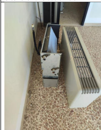
Impianti di riscaldamento disattivati
