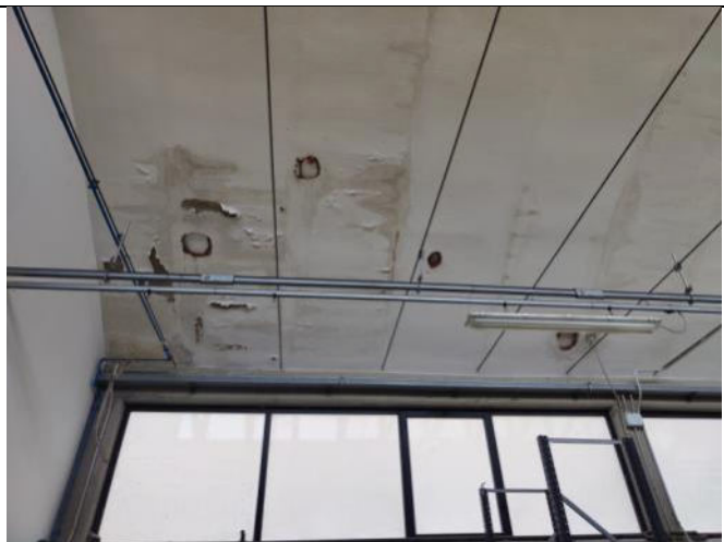
INFILTRAZIONI DALLA COPERTURA
