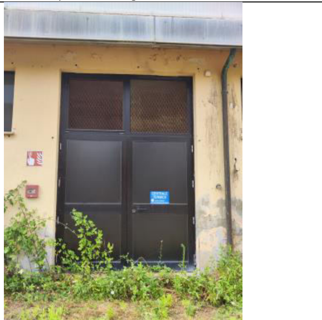
Porta accesso centrale termica industriale
