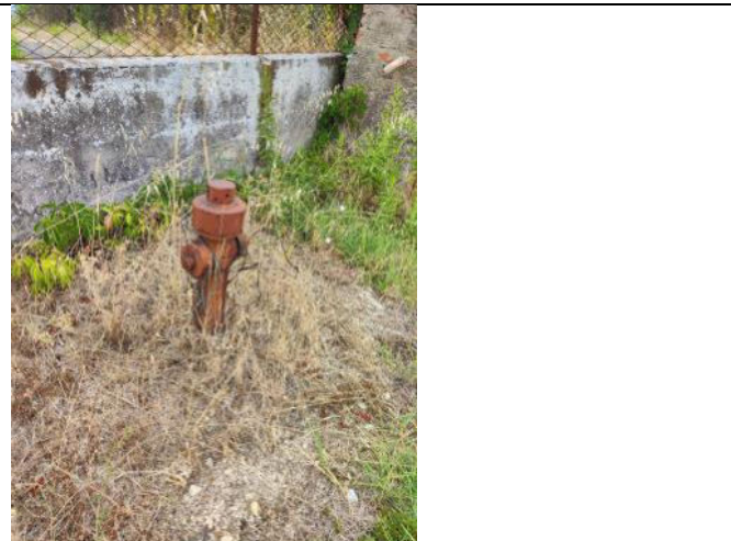
Impianto idrico antincendio presente nei pressi del cancello
