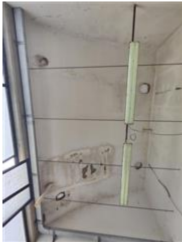
Infiltrazioni dal soffitto dell'opificio
