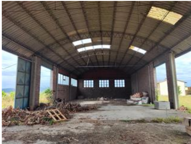
Magazzino in stato di abbandono
