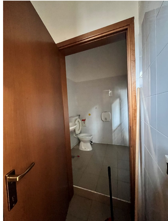
Immagine 17. Il bagno del personale adiacente al locale di preparazione da cui è separato con un antibagno.
