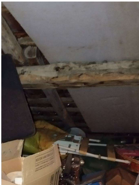
Dettagli – travi copertura ammalorate
