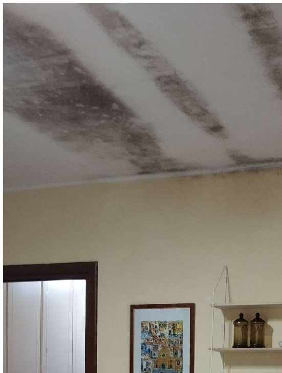
Dettagli – umidità cucina
