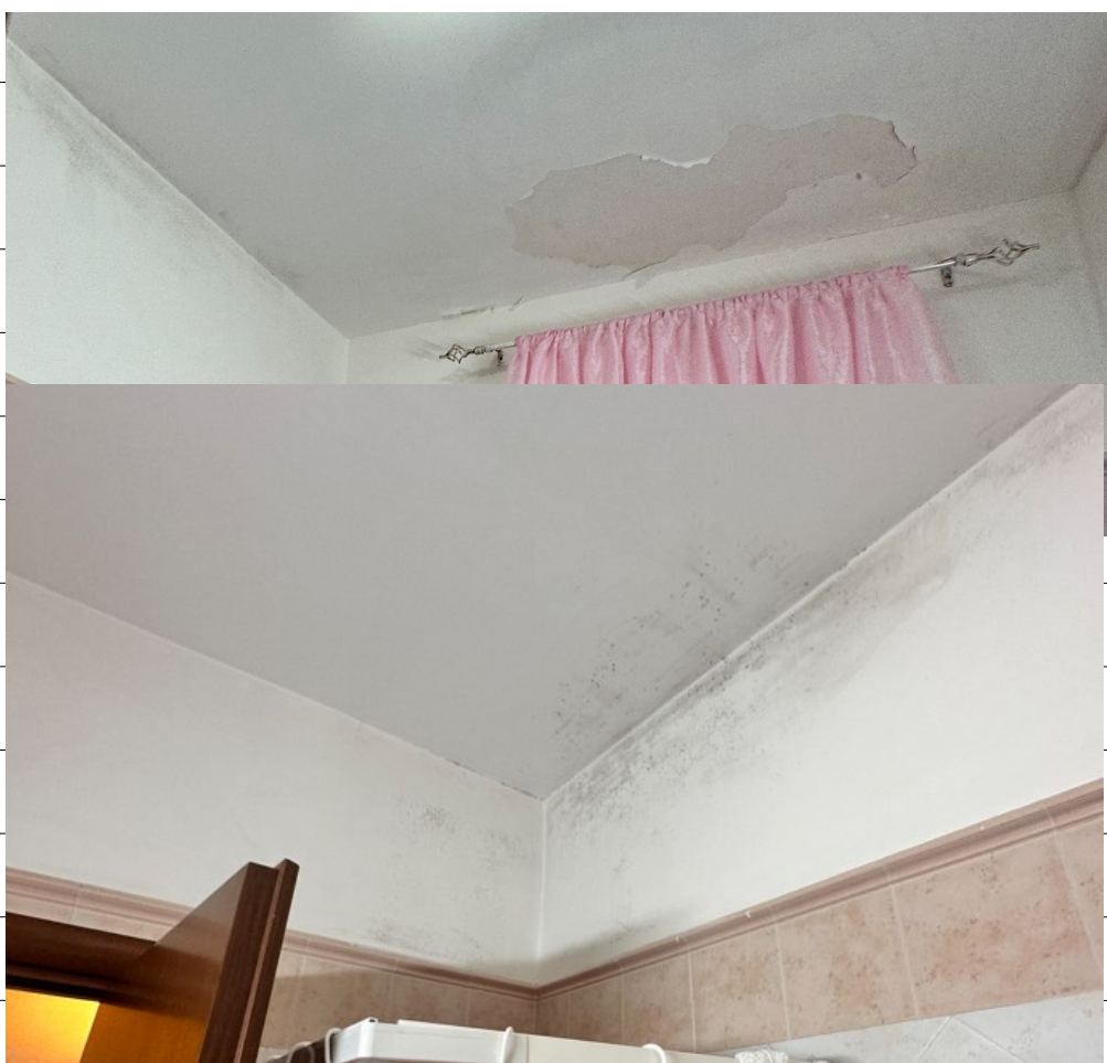
Servizio igienico con doccia, presenza di condensa umidità che hanno comportato l'esfoliazione del primo stato di intonaco
