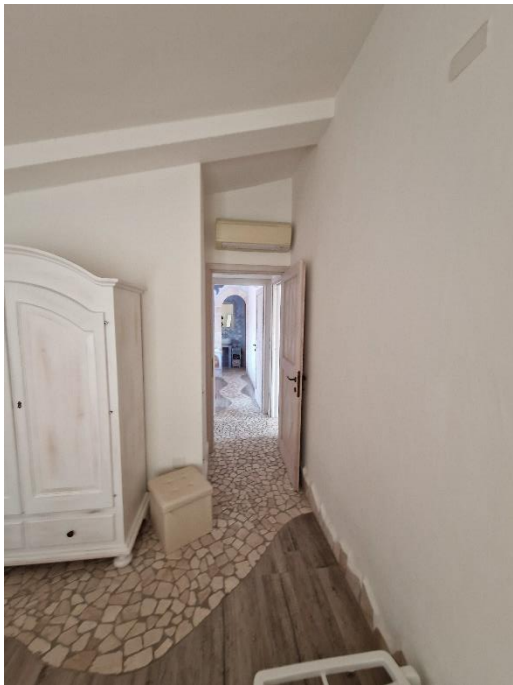
Unità interna letto lato veranda
