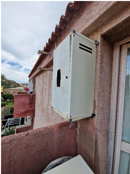
Balcone con caldaia a gas acs
