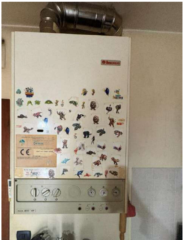
Dettaglio della caldaia, in cucina.
