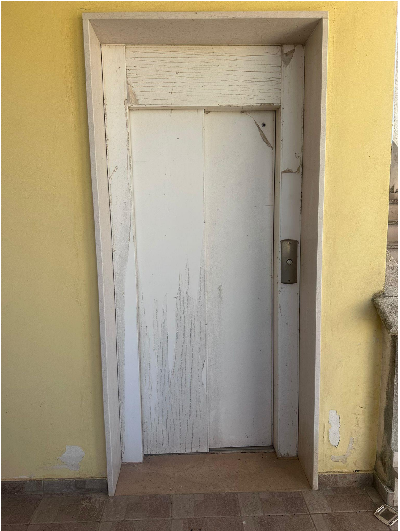
DOC. 15-16: ASCENSORE CONDOMINIALE CHE CONDUCE FINO AL PIANO 3°, NON FUNZIONANTE.
