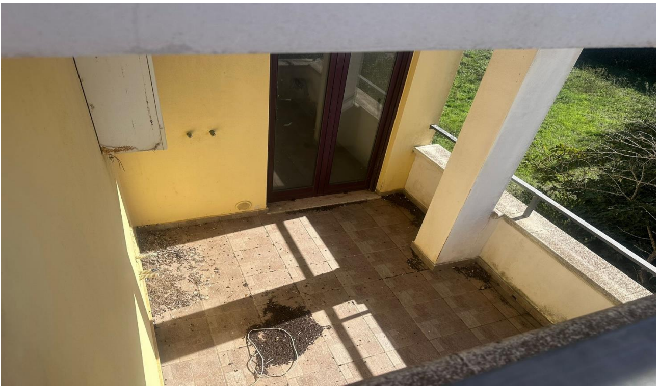
FOTO 20-21: CALDAIA RELATIVA ALL'ABITAZIONE DI PROPRIETA' MAURIZIO FORTE
