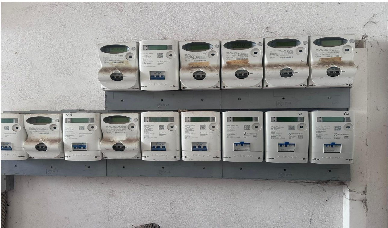
FOTO 14: CONTATORI ENERGIA ELETTRICA IN GRAN PARTE NON ATTIVI, POSTI AL PIANO TERRA.
