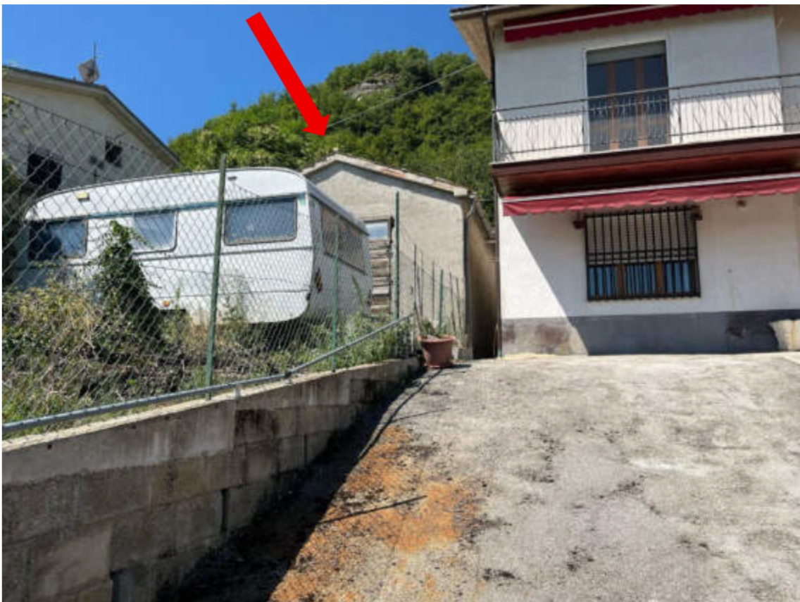
Foto 33 Sub. 5 Manufatto Inagibile
