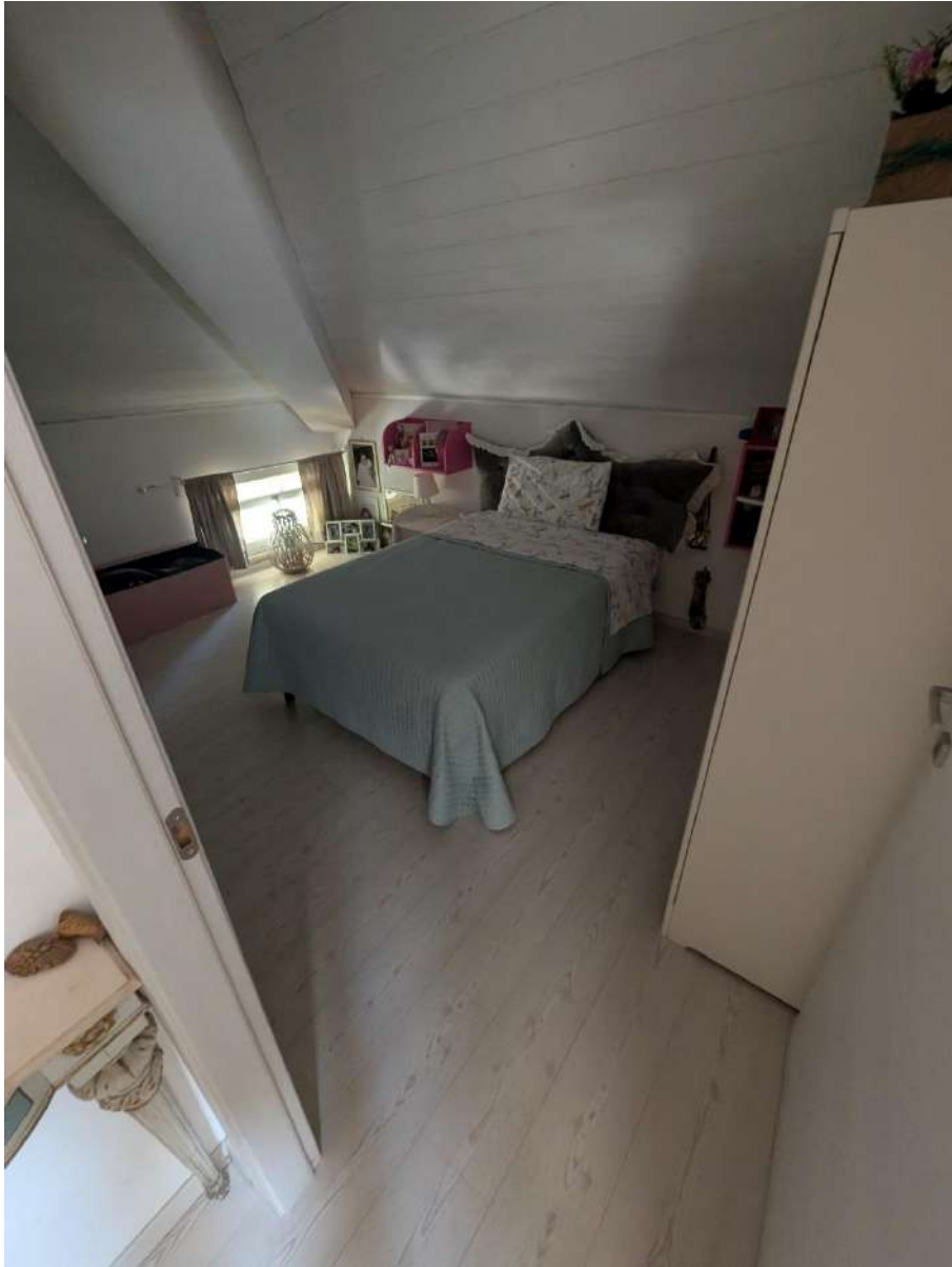
FOTO N° 43 – vano adibito abusivamente a Camera
