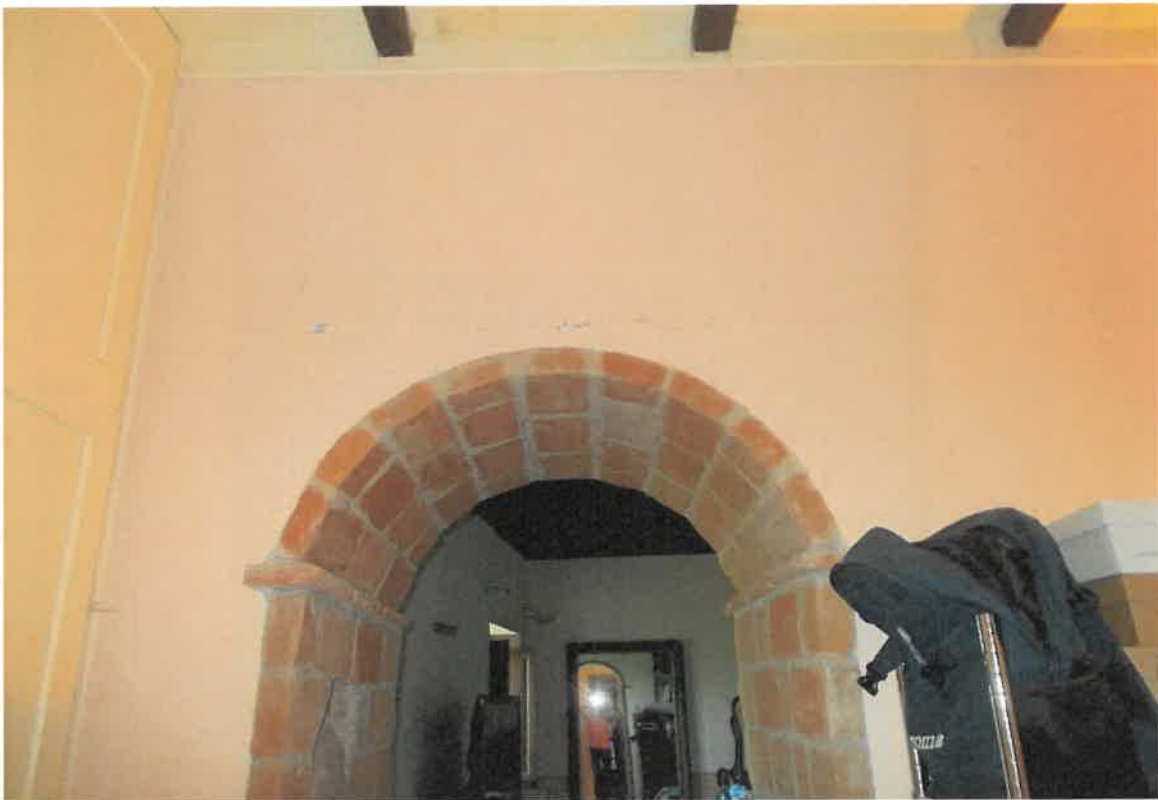
10. Particolare interno – crepe locali al piano terra
