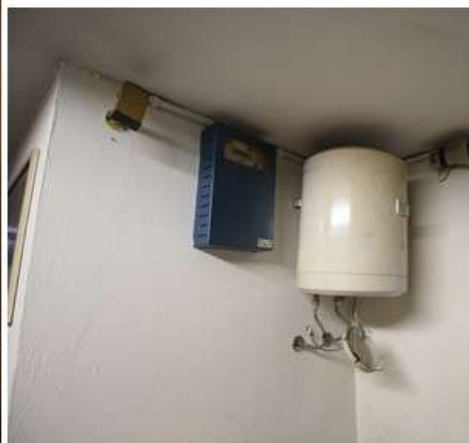
Foto 15: boiler e allarme posti accanto al bagno
