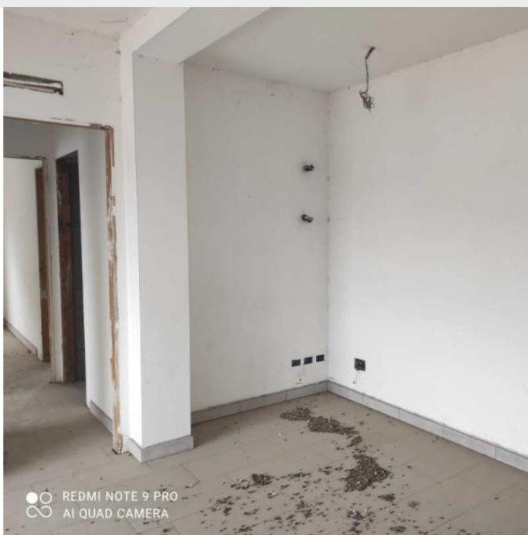
Foto n.10: degrado biologico con accumuli di guano di volatili;
