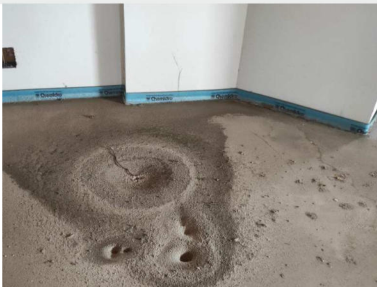
Foto n.8: presenza di infiltrazioni di acqua meteorica all'interno dell'appartamento ubicato al piano sottotetto del nuovo edificio;
