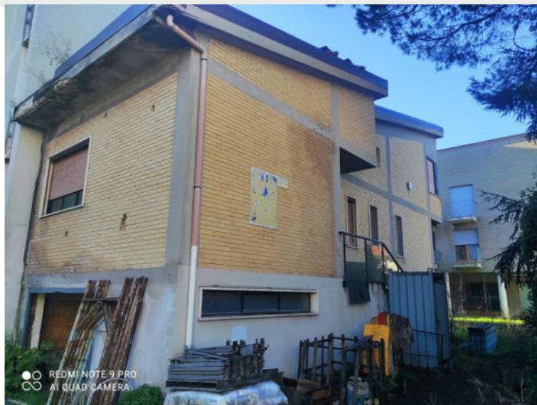
Foto n.2: presenza di materiali edili inutilizzati, attrezzature di cantiere abbandonate;
