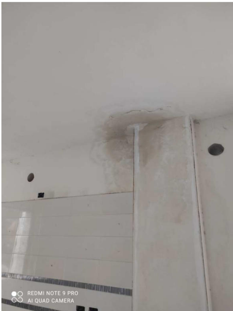
Foto n.9: presenza di infiltrazioni di acque meteoriche all'interno dell'unità abitativa identificata con l'interno3;
