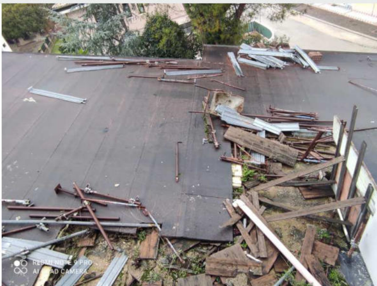
Foto n.7: particolare dello stato di abbandono e di degrado del cantiere (copertura villino);
