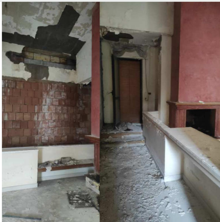
Foto n.5: infiltrazioni d'acqua meteorica con distacchi di intonaci all'interno del villino;
