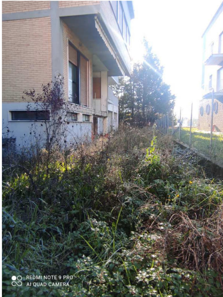
Foto n.4: presenza di vegetazione spontanea all'interno della corte pertinenziale degli edifici;
