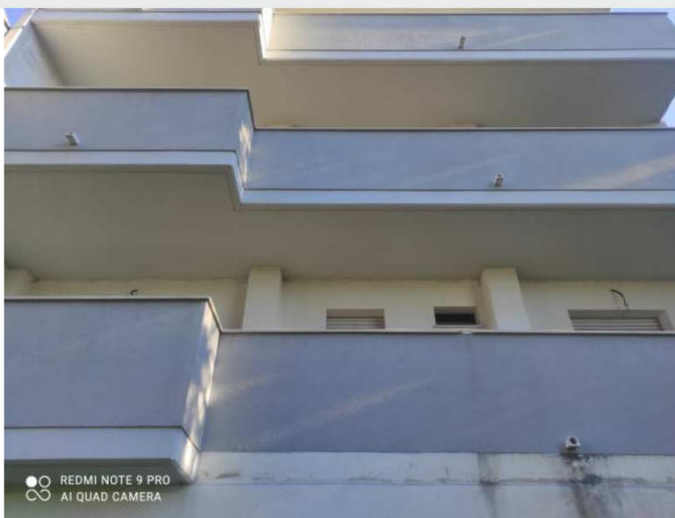
Foto n.50: facciata dell'edificio esposta a Sud-Ovest con finitura esterna mancante;
