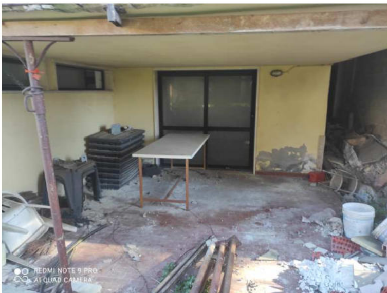
Foto n.6: particolare dello stato di abbandono e di degrado del cantiere;
