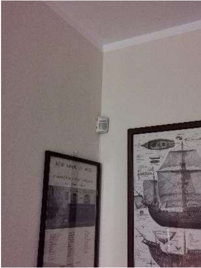
Foto 18) Part. impianto allarme
