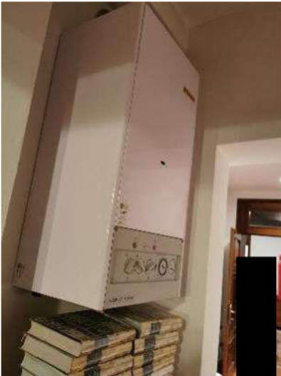
Foto 79) Part. generatore di calore nel disimpegno P.T.
