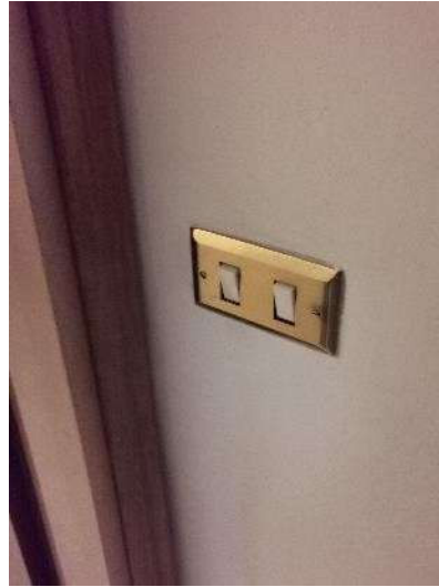
Foto 19) Part. impianto elettrico
