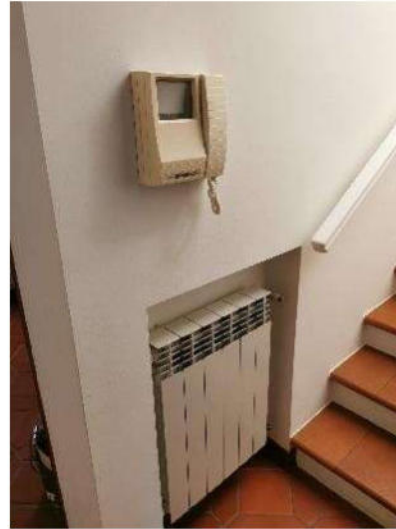
Foto 46) Part. videocitofono e termina emissione riscaldamento
