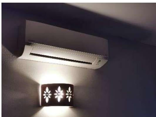
Foto 37) Part. interno – Unità interna impianto di climatizzazione
