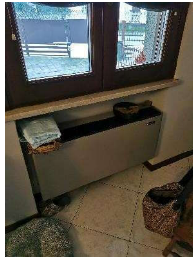
Foto 16) Part. interno – Terminale emissione riscaldamento
