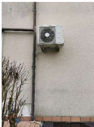
Foto 36) Part. interno – Unità esterna impianto di climatizzazione
