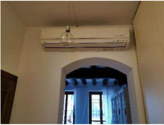
Foto 50) Part. impianto climatizzazione ingresso 1° piano
