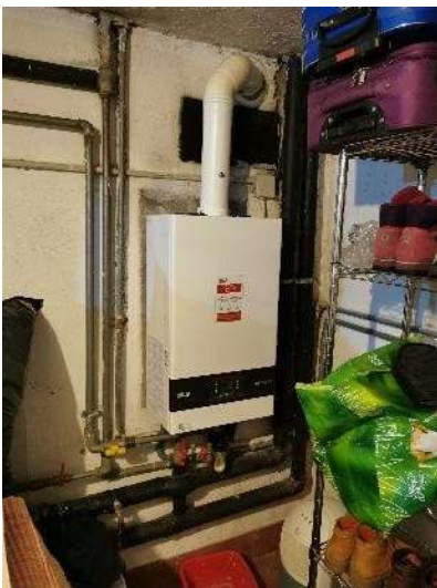
Foto 27) Part. interno – Caldaia loc. cantina
