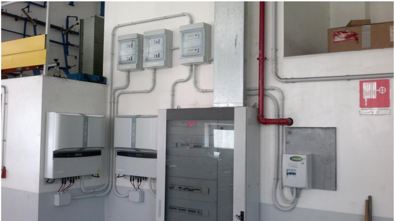
Inverter ubicato al Piano Seminterrato
