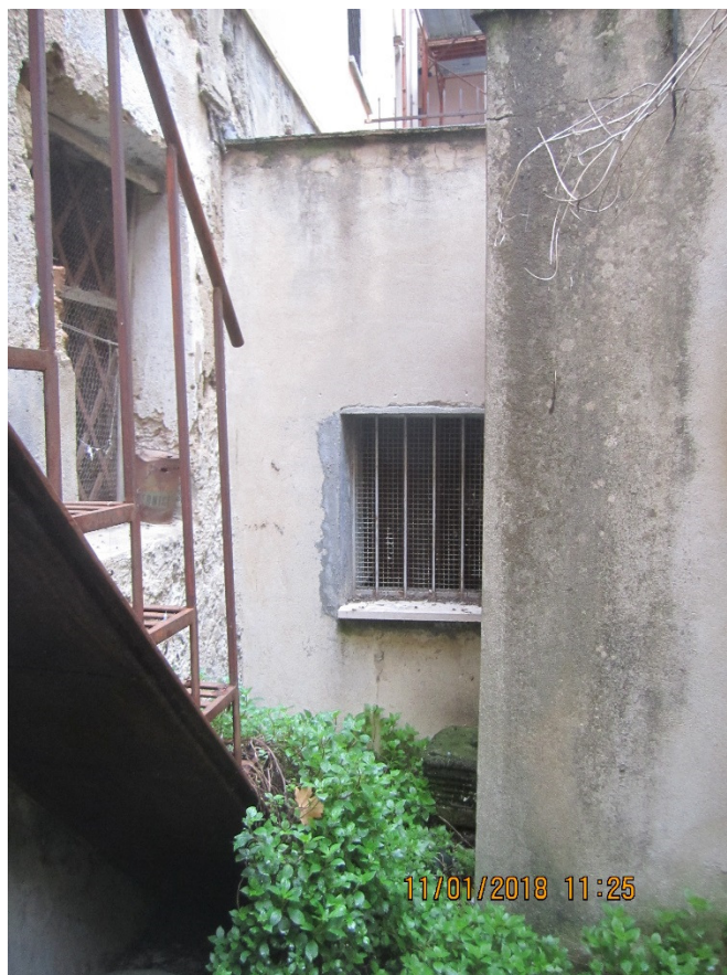
Foto 3: servizio igienico in abuso
