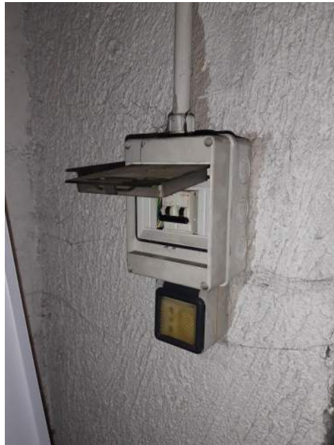
Dettaglio impianto elettrico
