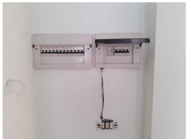
Dettaglio impianto elettrico
