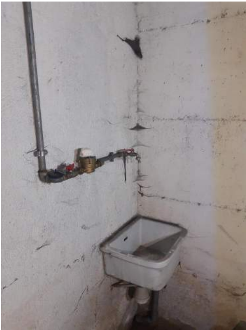
Dettaglio impianto idrico
