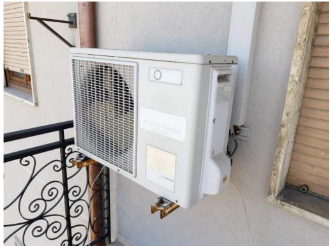
Vista del sistema AC sul balcone
