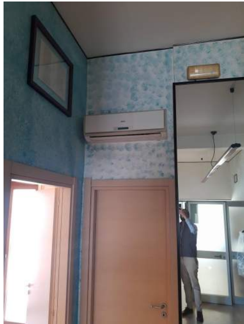
Vista dell'ambiente di disimpegno (sistema aria condizionata)
