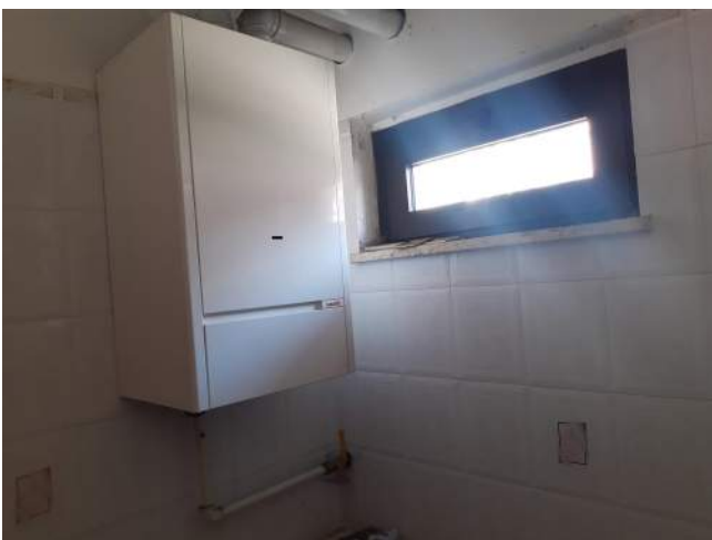
Dettaglio del bagno e della caldaia
