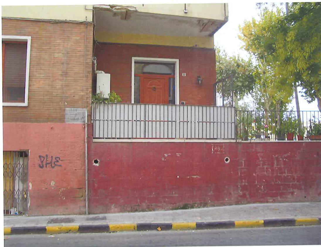
Figura 38- Prese d'aria locale di proprietà comune al condominio.
