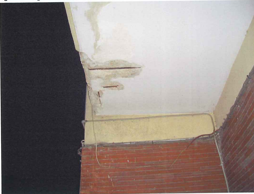
Figura 36- Lesione ingresso lato via Bastioni Carlo V.
