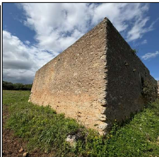
Foto_24 Particolare degrado
