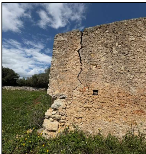
Foto_25 Particolare degrado
