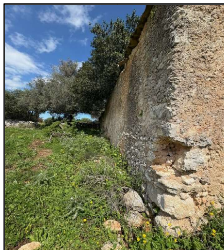
Foto_26 Particolare degrado
