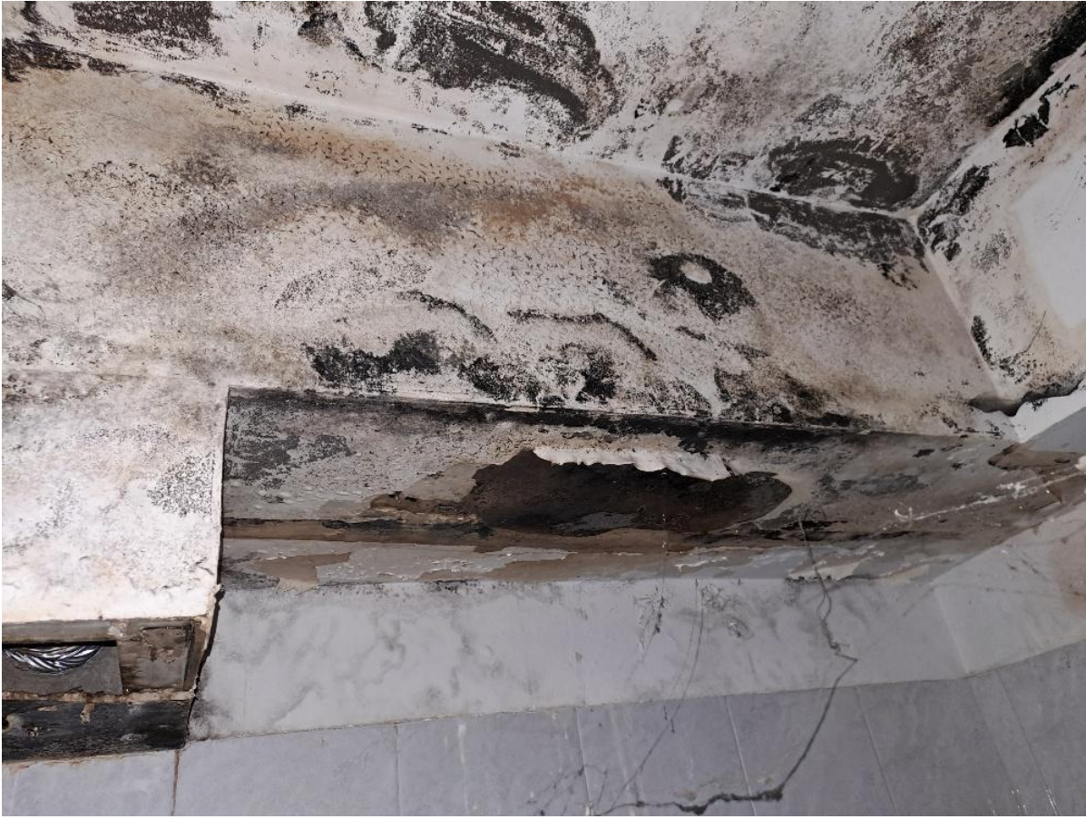
PARTICOLARE DEL SOFFITTO E DELLA PARETE DANNEGGIATA DEL BAGNO 1
