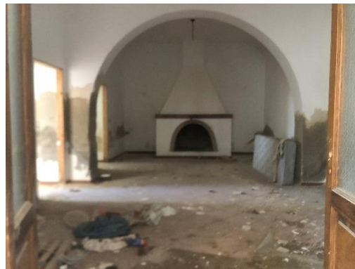
INTERNO LOCALI EX DEPOSITO DEVASTATI
