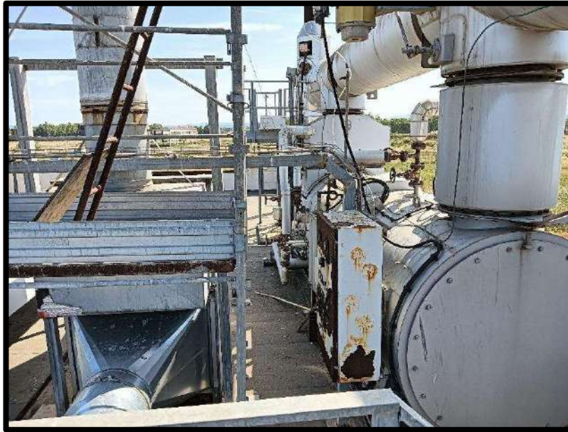
Foto 29 - Impianti sulla copertura
