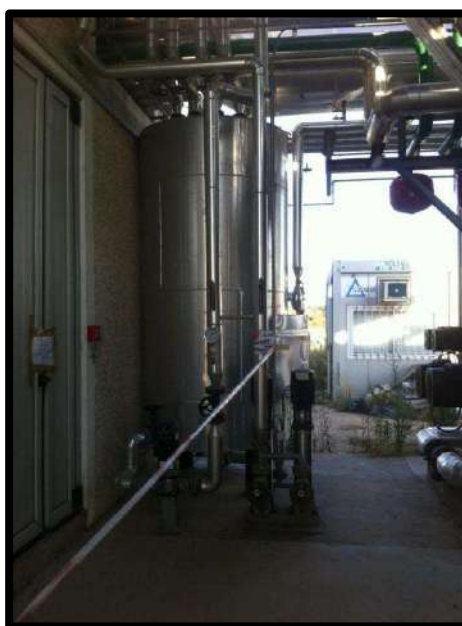
Foto 7 - Recupero termico (serbatoio aliment. Caldaia)
