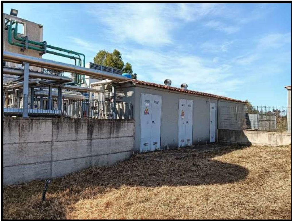
Foto 17 - Vista generale cabine elettriche (esterno lotto)
