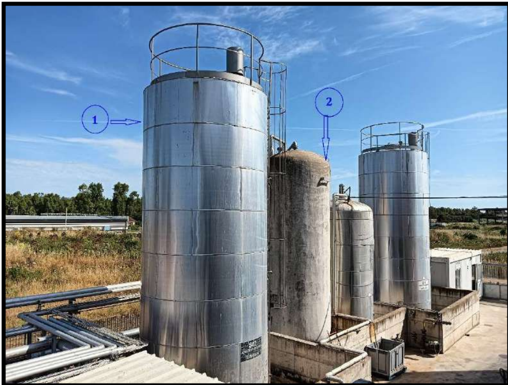
Foto 13 -Silos per biocombustibile ed urea
