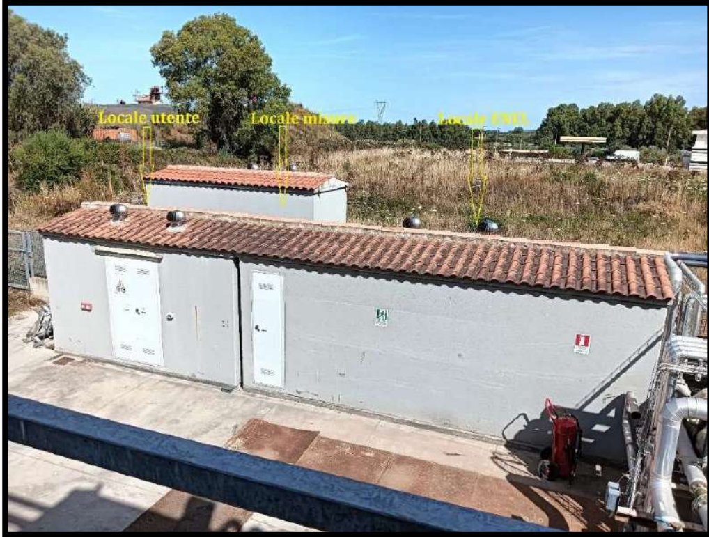
Foto 16 - Vista generale cabine elettriche (interno lotto)
