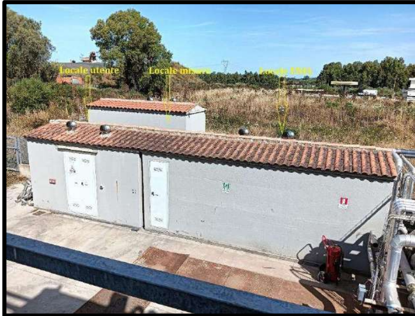
Foto 16 - Vista generale cabine elettriche (interno lotto)
