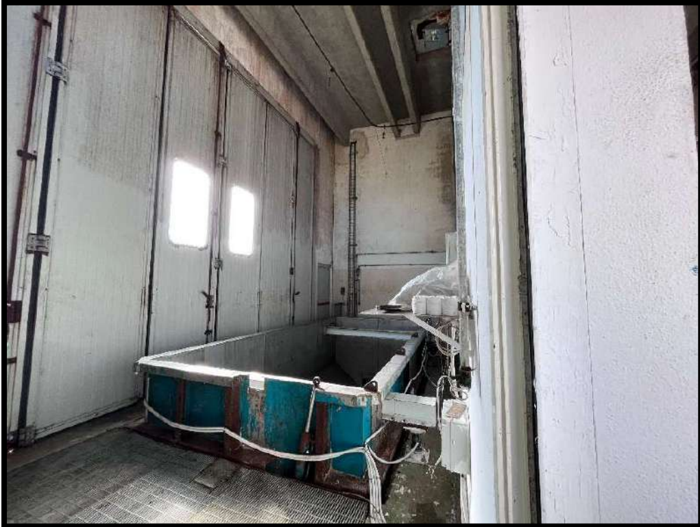
Foto 22 - Tramoggia di carico
