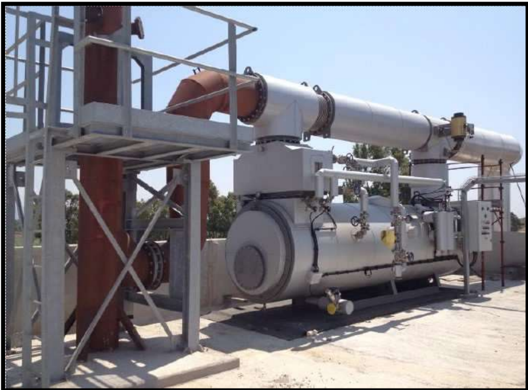
Foto 5 - Caldaia recupero termico
