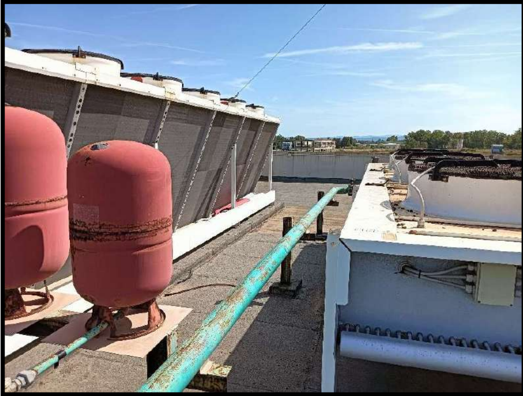
Foto 28 - Impianti sulla copertura
