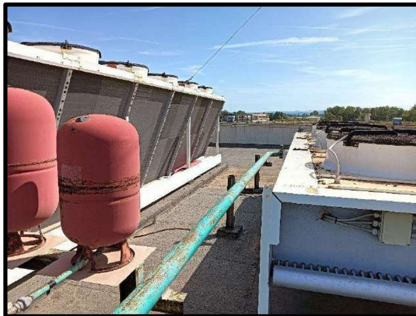
Foto 28 - Impianti sulla copertura
