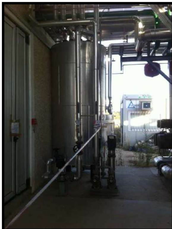
Foto 7 - Recupero termico (sebatoio alimnet. Caldaia)
