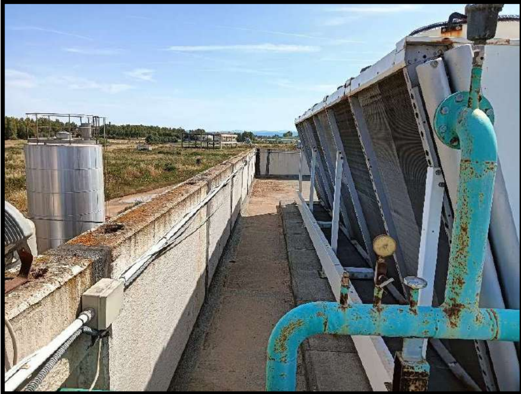
Foto 30 - Impianti sulla copertura
