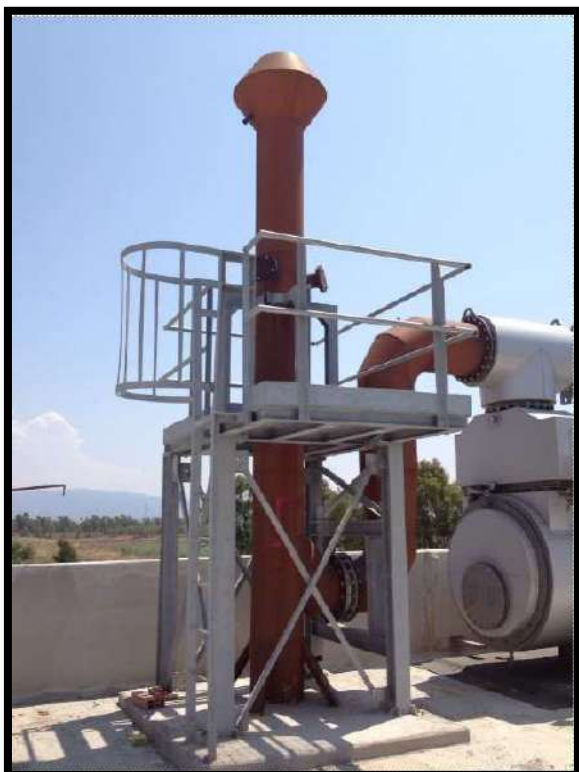
Foto 6 - Recupero termico (espulsione fumi)
