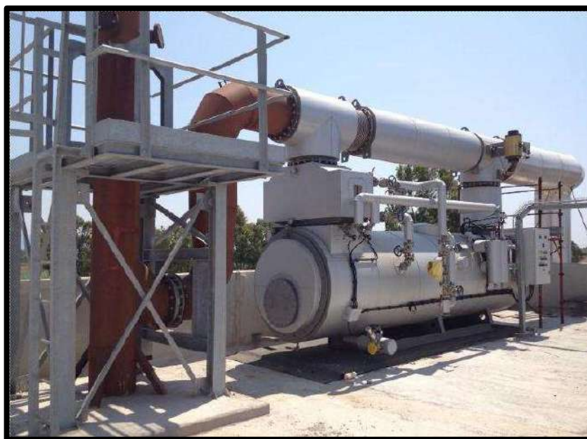
Foto 5 - Caldaia recupero termico
