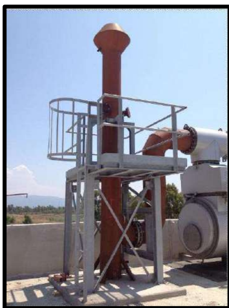
Foto 6 - Recupero termico (espulsione fumi)
