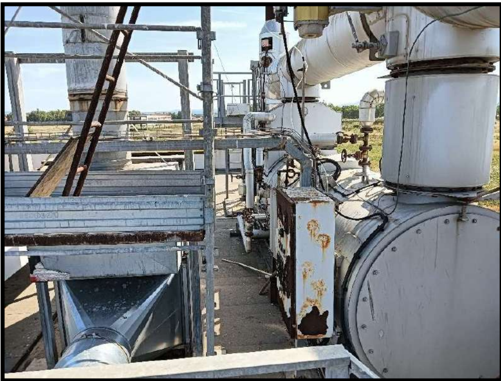
Foto 29 - Impianti sulla copertura
