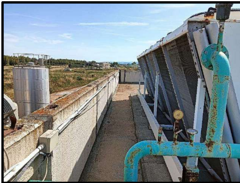
Foto 30 - Impianti sulla copertura
