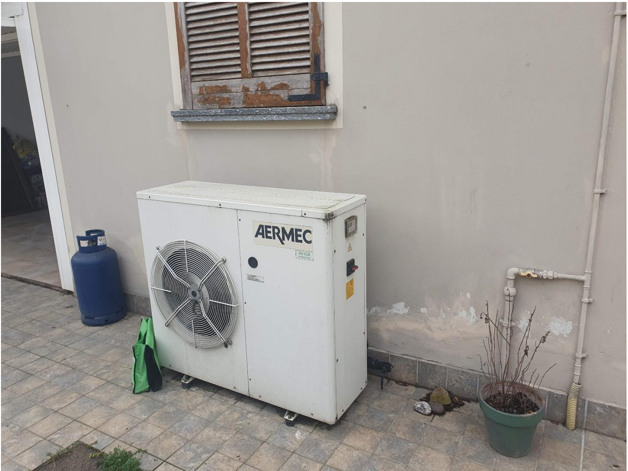
FOTOGRAFIA 58: macchina esterna per i convettori.
