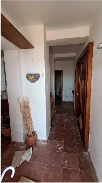
Ingresso 1 - Umidità di risalita e lesione pilastro
