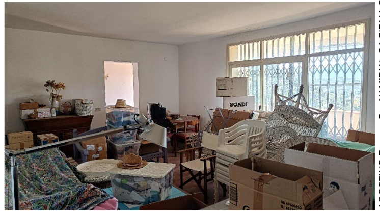
Soggiorno 2 - Lesione architravi
