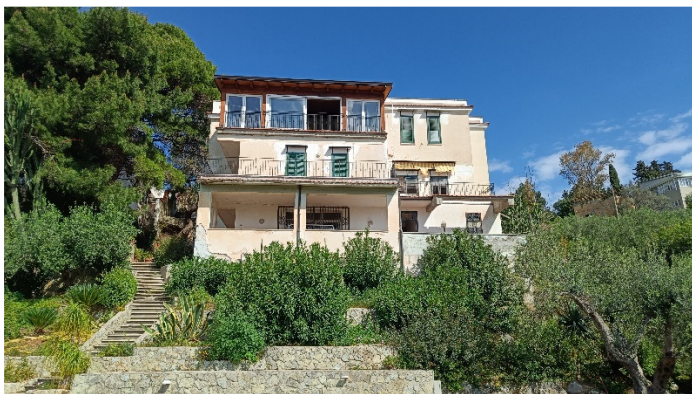
Prospetto – Distacco di intonaco
