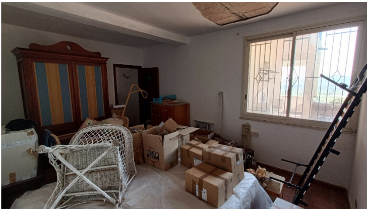
Camera 4 - Lesione trave e distacco di intonaco soffitto
