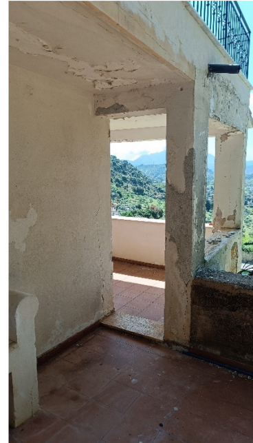
Terrazzo 10 – Intonaci ammalorati e infiltrazione superiore
