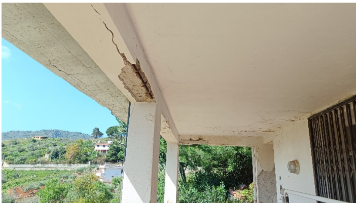
Terrazzo 10 - Lesioni trave, pilastri e pensilina
