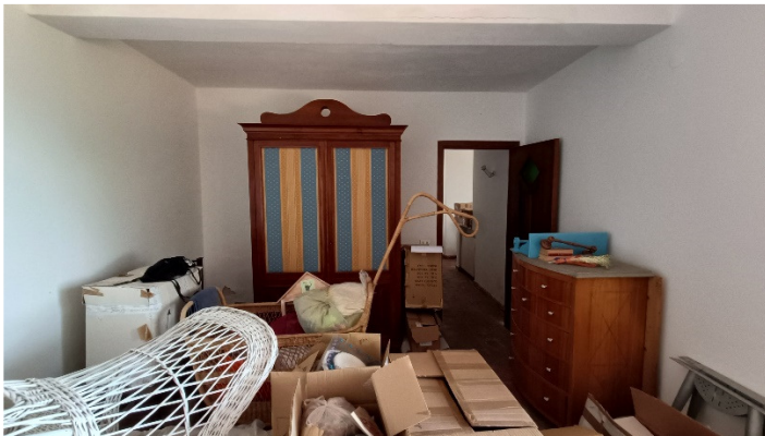
Camera 4 - Umidità di risalita
