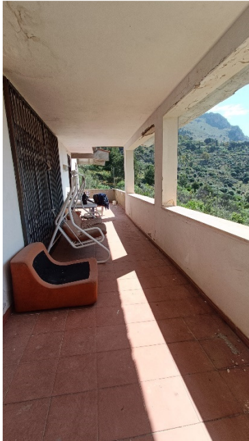
Terrazzo 10 - Lesione trave e infiltrazione soffitto
