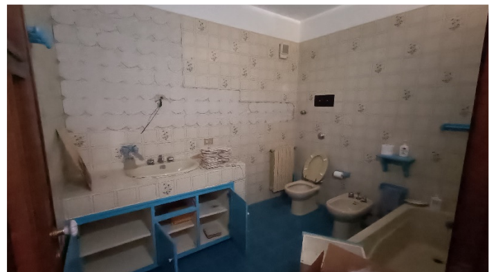
Bagno 5 – Distacco di piastrelle
