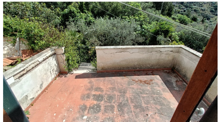
Terrazzo 11 - Lesione parapetto e ferri scoperti
