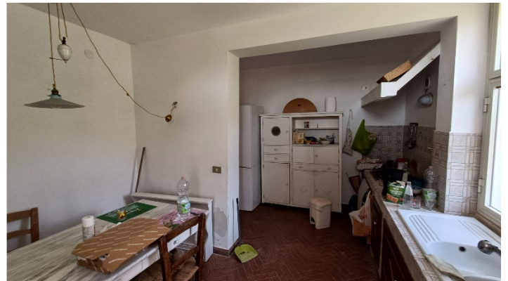
Cucina 9 - Umidità di risalita
