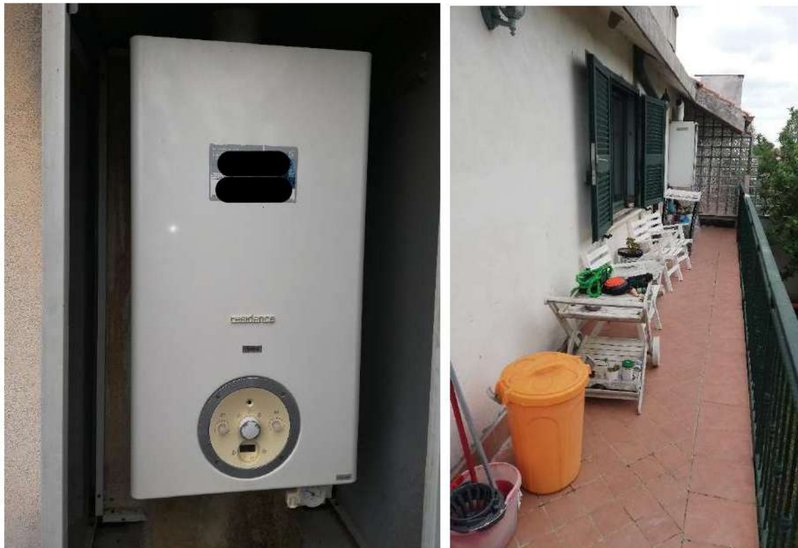
Rilievo Fotografico: Caldaia posta sul prospetto Sud-Ovest dell'immobile.
