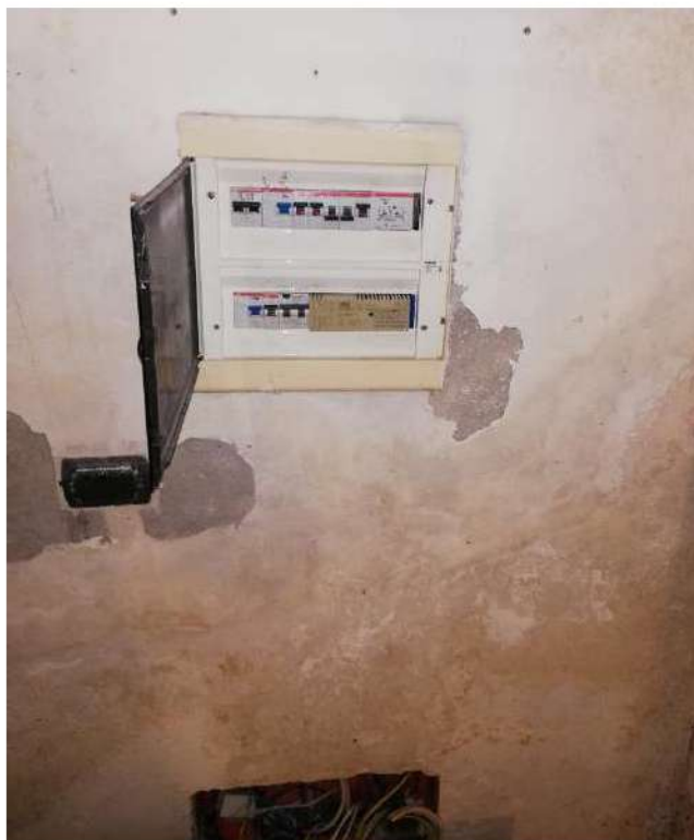
Rilievo Fotografico: Quadro elettrico impianto illuminazione esterna.
