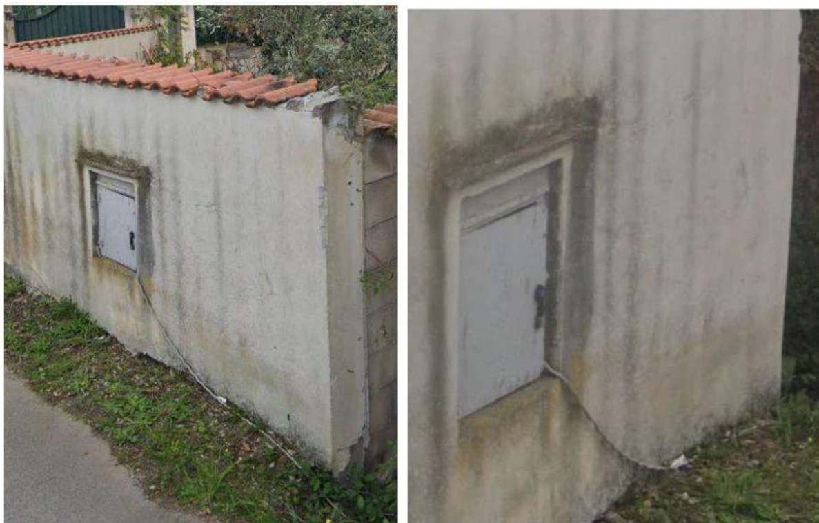
Rilievo Fotografico: Contatore energia elettrica posto sul muro di confine del cespite lato Via Palestrina. E' visibile un cavo elettrico che esce dalla cassetta in cui è installato il contatore. Il cavo per un tratto costeggia il muro di recinzione su Via Palestrina per poi immettersi nella cunetta a lato della strada.
