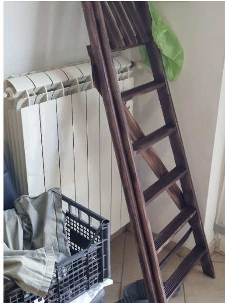
Particolare impianto di riscaldamento
