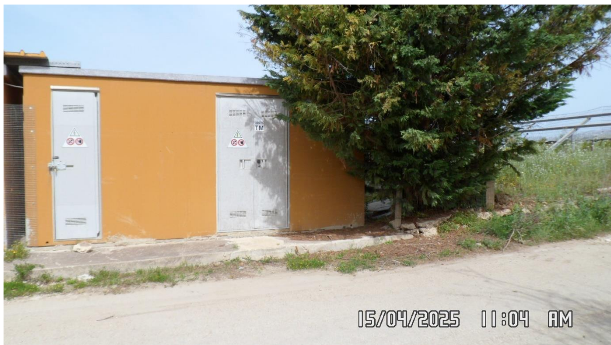
Foto 4 – Veduta della cabina elettrica
