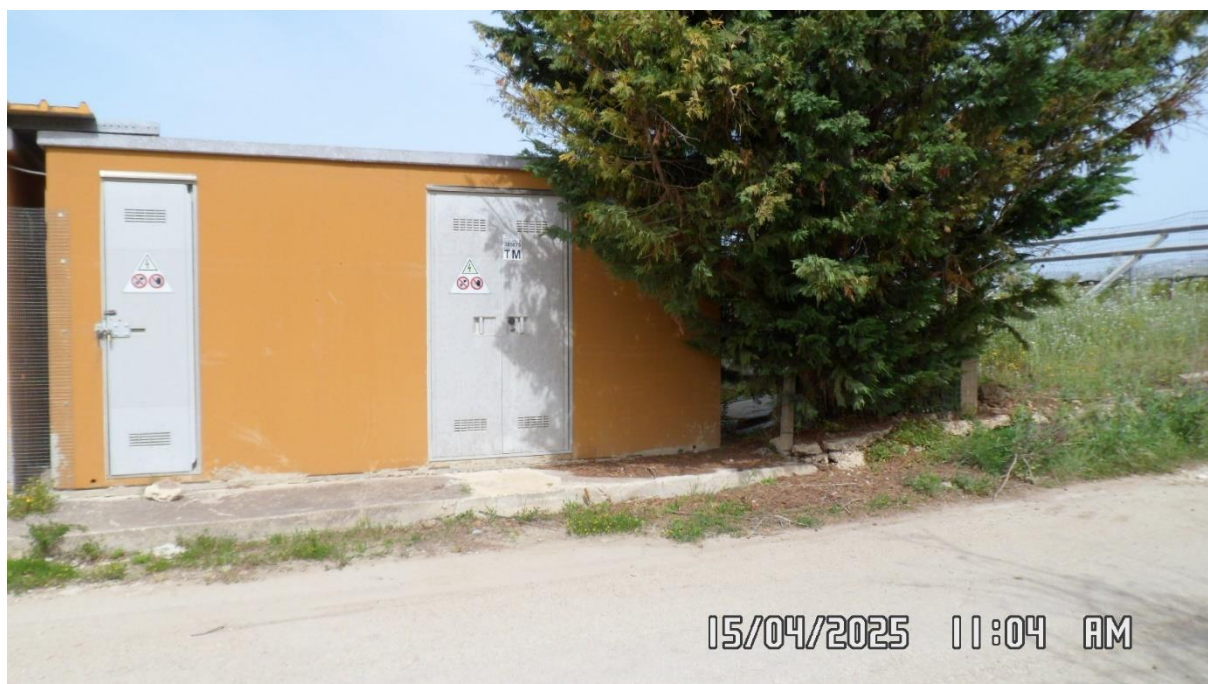
Figura 3 – Vista della cabina elettrica.
