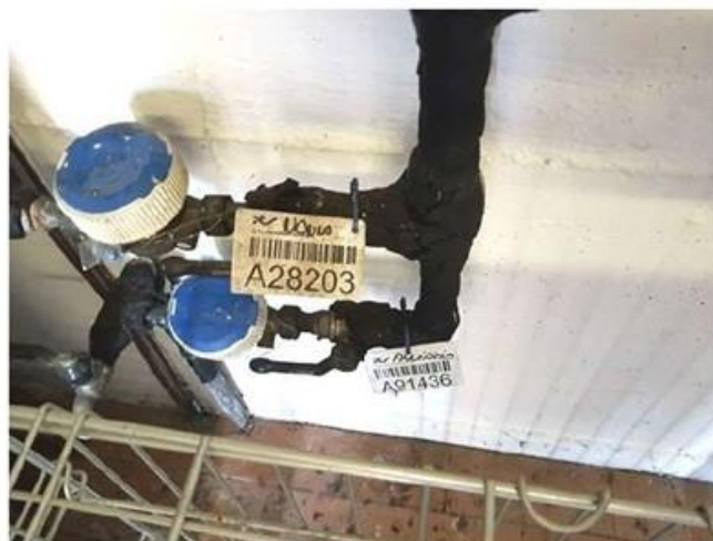
71 – Contatori nel locale centrale termica
