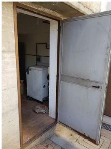
67 – Ingresso alla centrale termica
