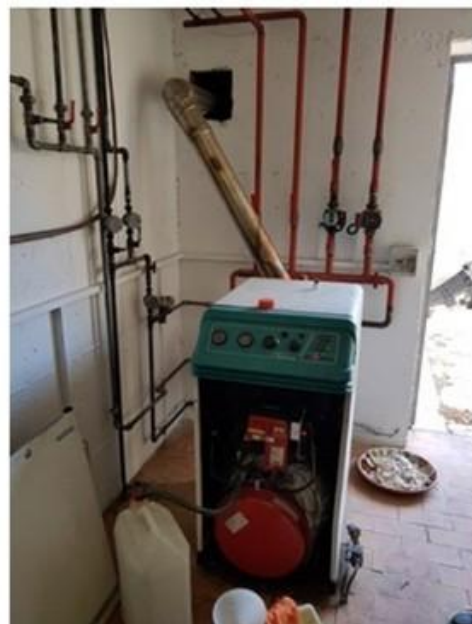
69 – il bruciatore all'interno del locale centrale termica
