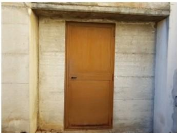
66 – Porta d'accesso al locale centrale termica
