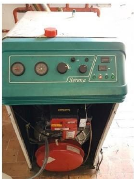
70 – Particolare del bruciatore
