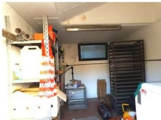
68 – Il locale centrale termica
