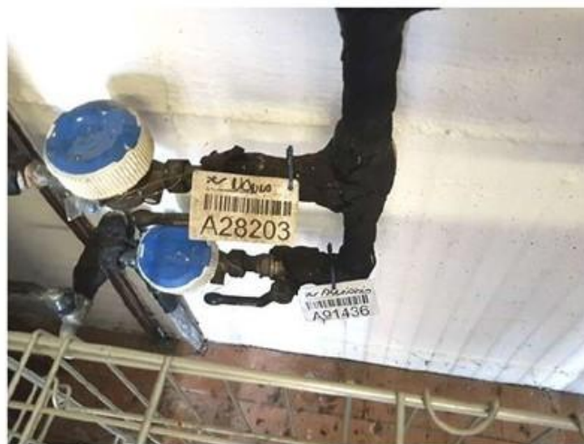
71 – Contatori nel locale centrale termica
