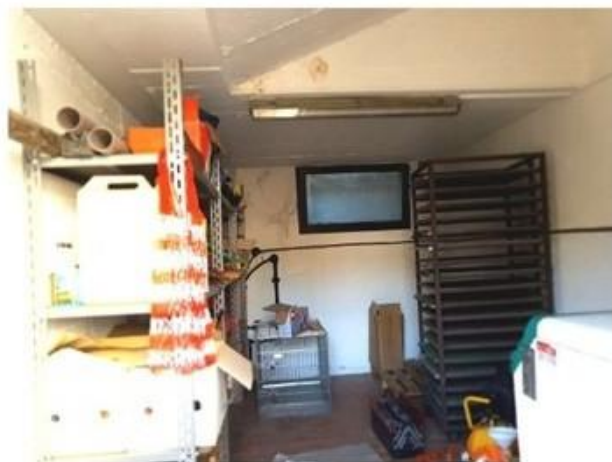
68 – Il locale centrale termica
