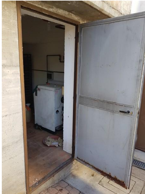
67 – Ingresso alla centrale termica
