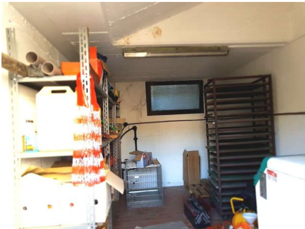
68 – Il locale centrale termica
