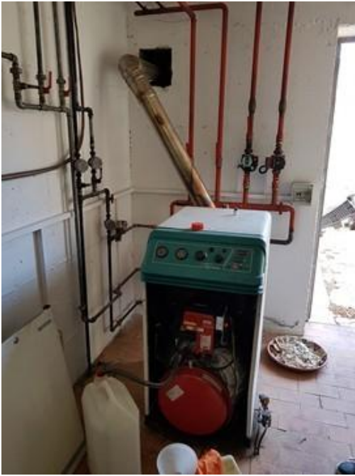
69 – il bruciatore all'interno del locale centrale termica
