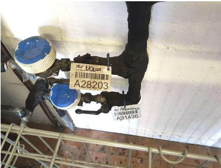
71 – Contatori nel locale centrale termica
