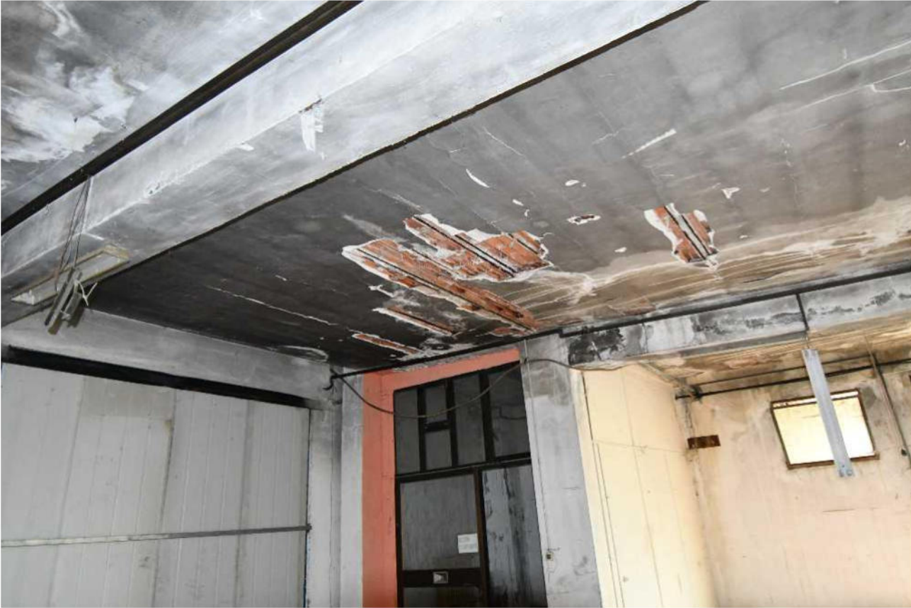
sfondellamenti travetti solai
