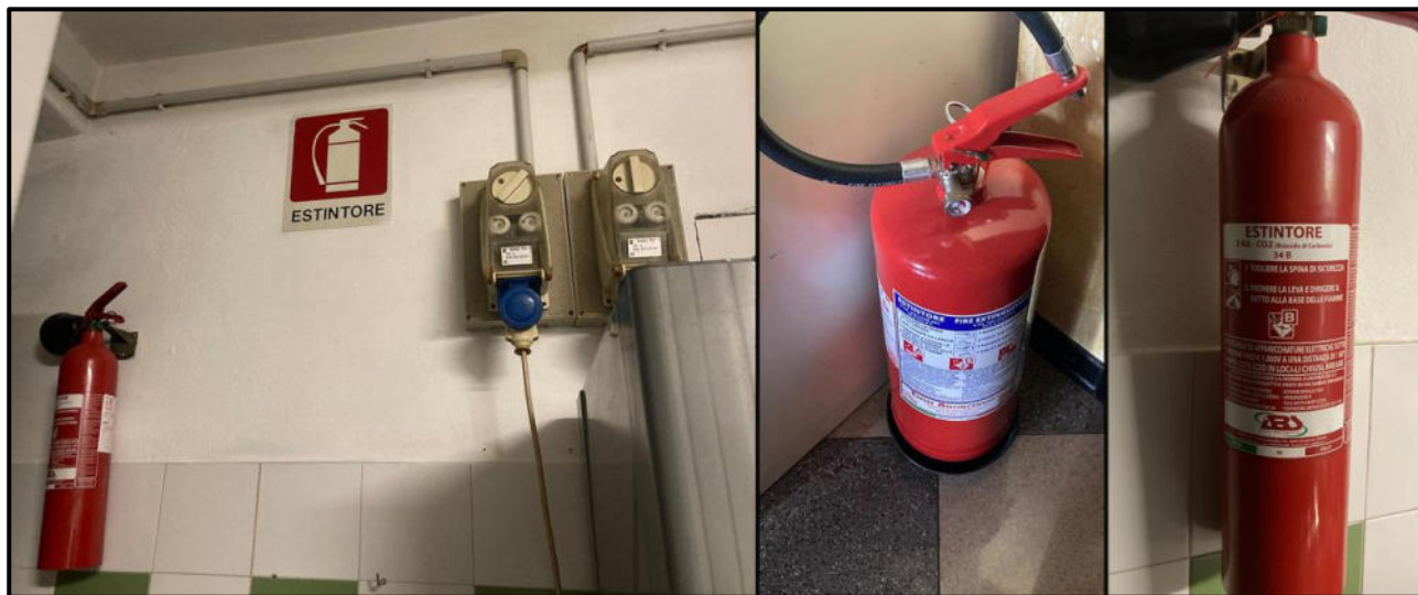
Impianto antincendio: estintori e relativa segnaletica
