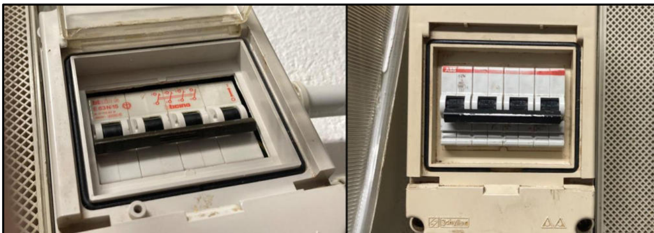
Impianto elettrico: quadretti e prese in cucina
