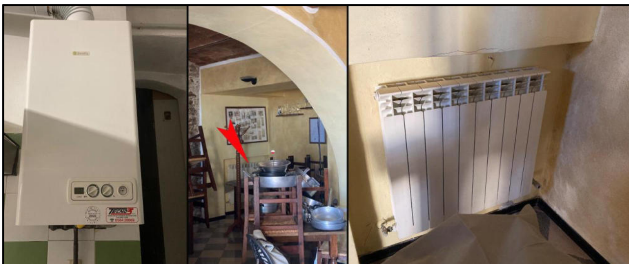
Impianto riscaldamento: caldaia e radiatore.
