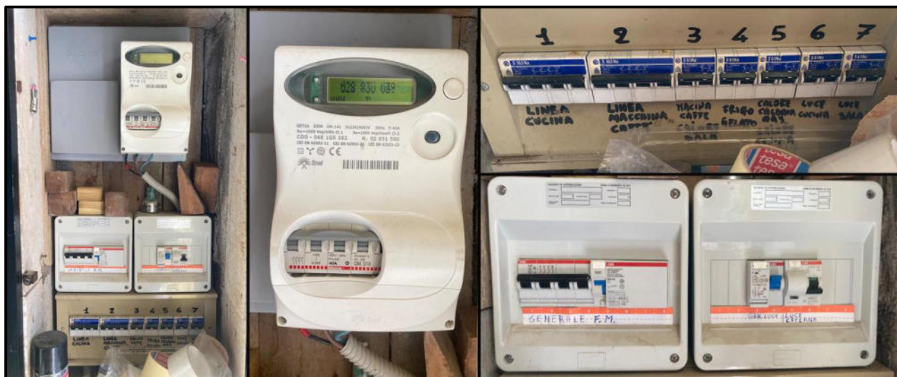
Impianto elettrico: punto di fornitura con alloggiamento contatore e quadretti
