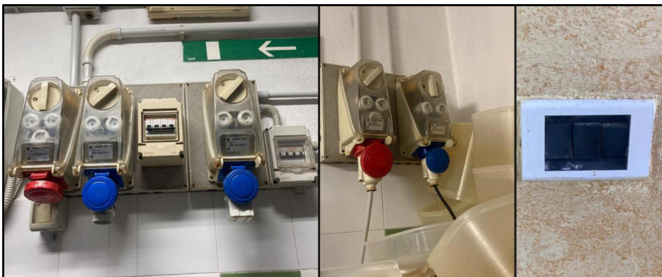
Impianto elettrico: dettagli dell'impianto
