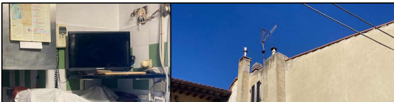
Impianto radio-televisivo: apparecchio tv in cucina e antenna condominiale in copertura
