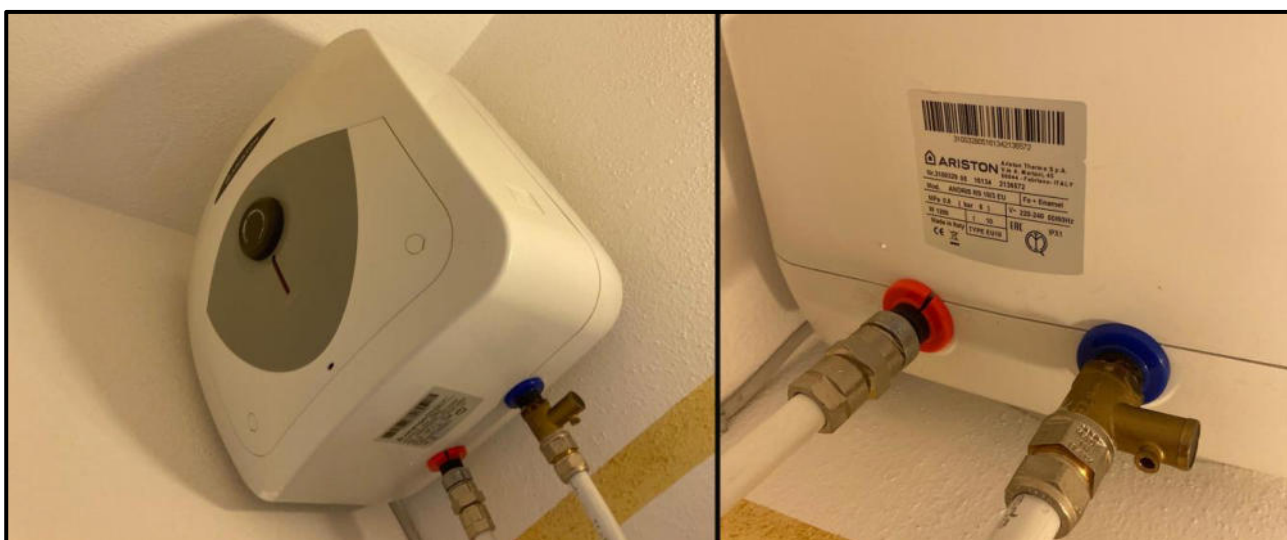
Impianto idrico: boiler elettrico per ACS in bagno
