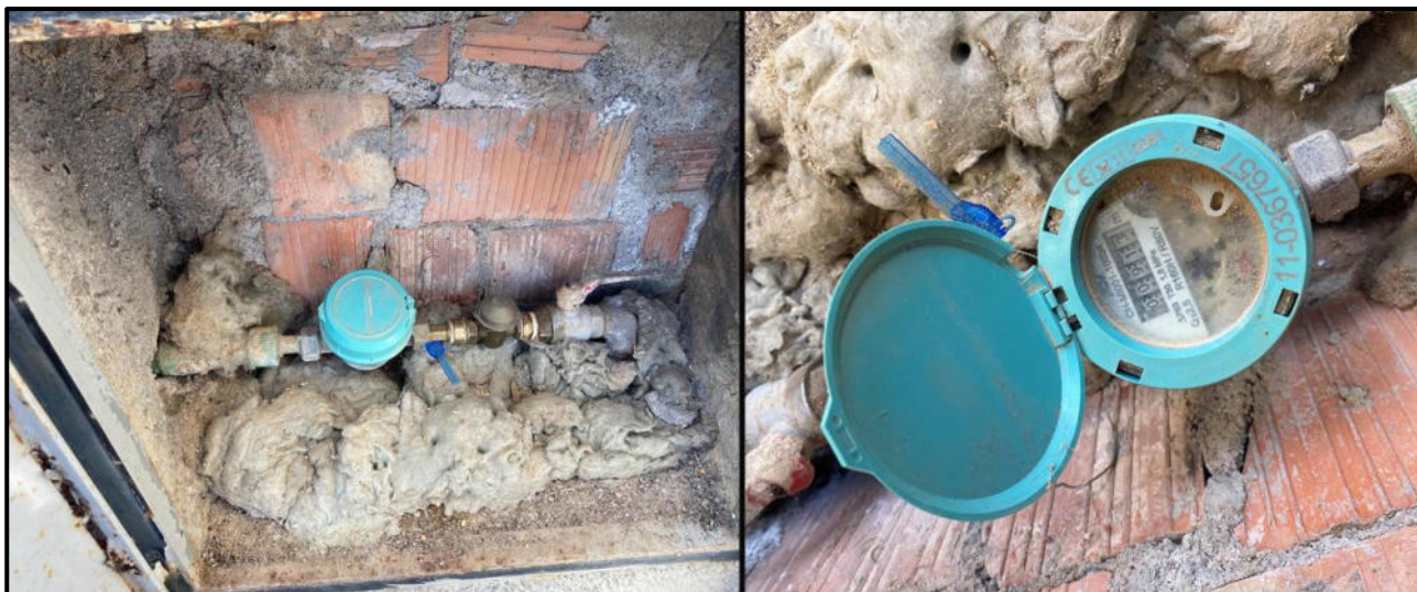
Impianto idrico: contatore in vano esterno ricavato nella muratura
