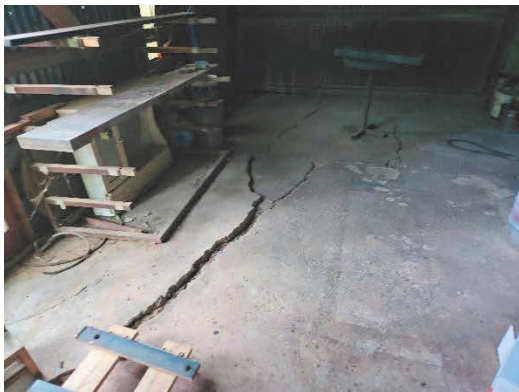
Lesioni nella pavimentazione
