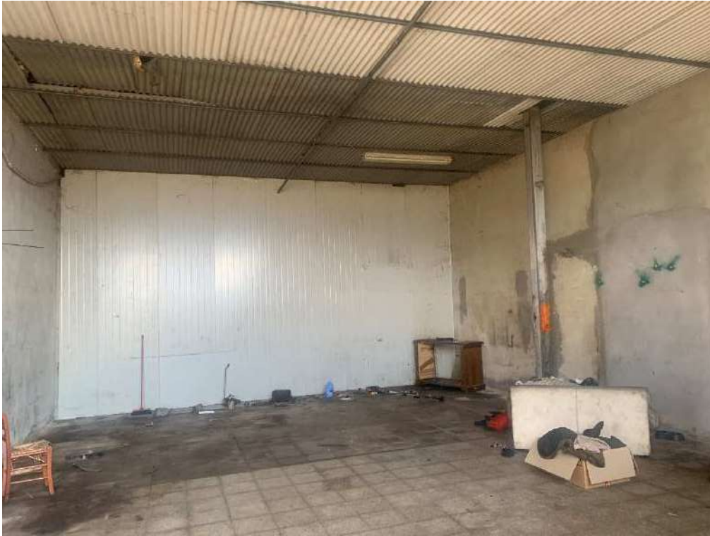
Vista interno parete abusiva
