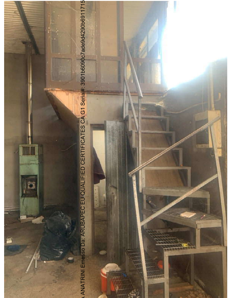
Vista interno w.c. piano terra e scala con pareti piano 1° abusive
