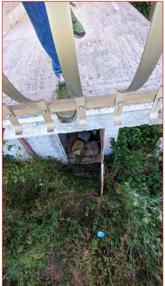
08 - Veduta ingresso alla centrale termica sotto al balcone
