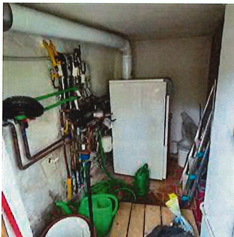
Impianto riscaldamento posto a piano terra nel locale centrale termica con accesso esterno
