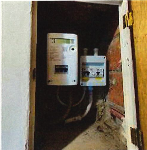
Contatore elettrico posto dentro i locali del risorante a piano terra
